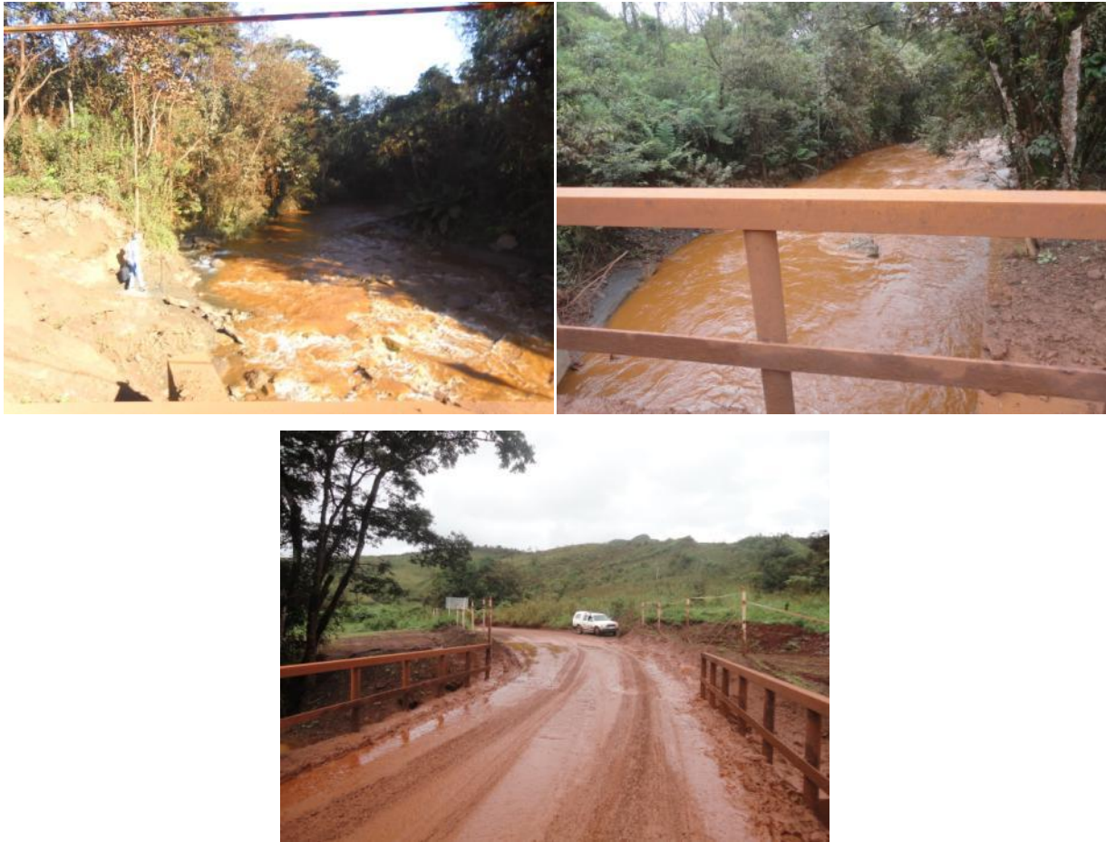
FIGURA 19. RIBEIRÃO DO SILVA SOB PONTE EM ESTRADA DE MINERAÇÃO. FONTE: MYR PROJETOS, 2013
