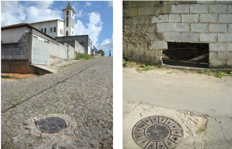
Figura 4.9 – Poços de visita da rede coletora de esgoto da sede de Caeté. Fonte: Cobrape, 13/06/13
