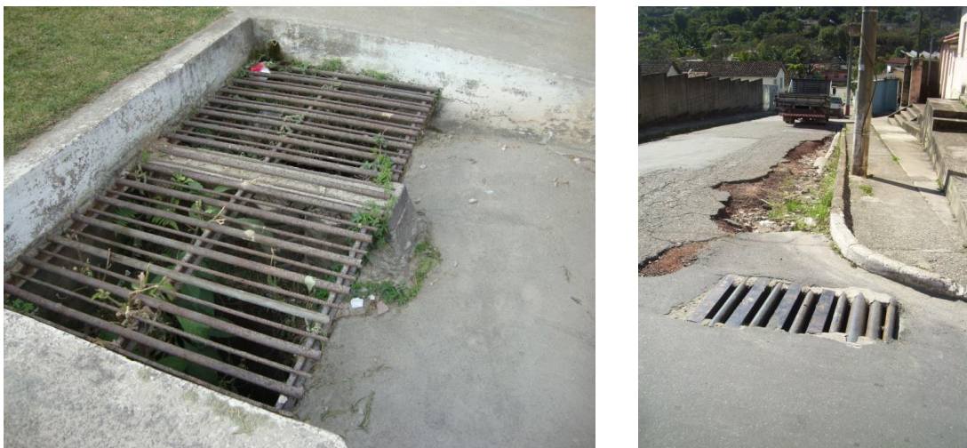
Figura 4.12 – Exemplo de dispositivos de captação de águas pluviais utilizados na sede de Caeté. Fonte: Cobrape, 22/05/13
