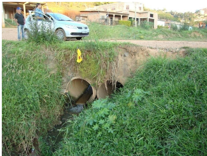
Dispositivos de drenagem junto ao Córrego Soberbo
