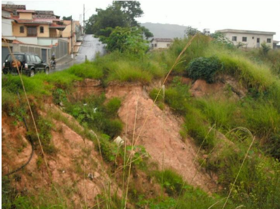
Foco de deslizamento na Vila Zelinda
