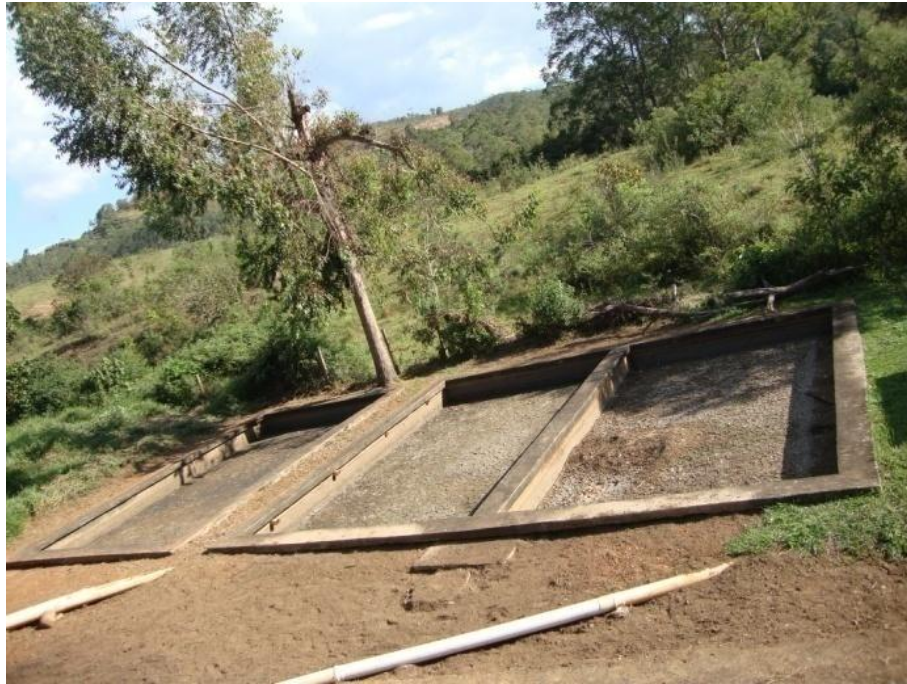
Figura 7.78 - Leito de secagem do lodo
