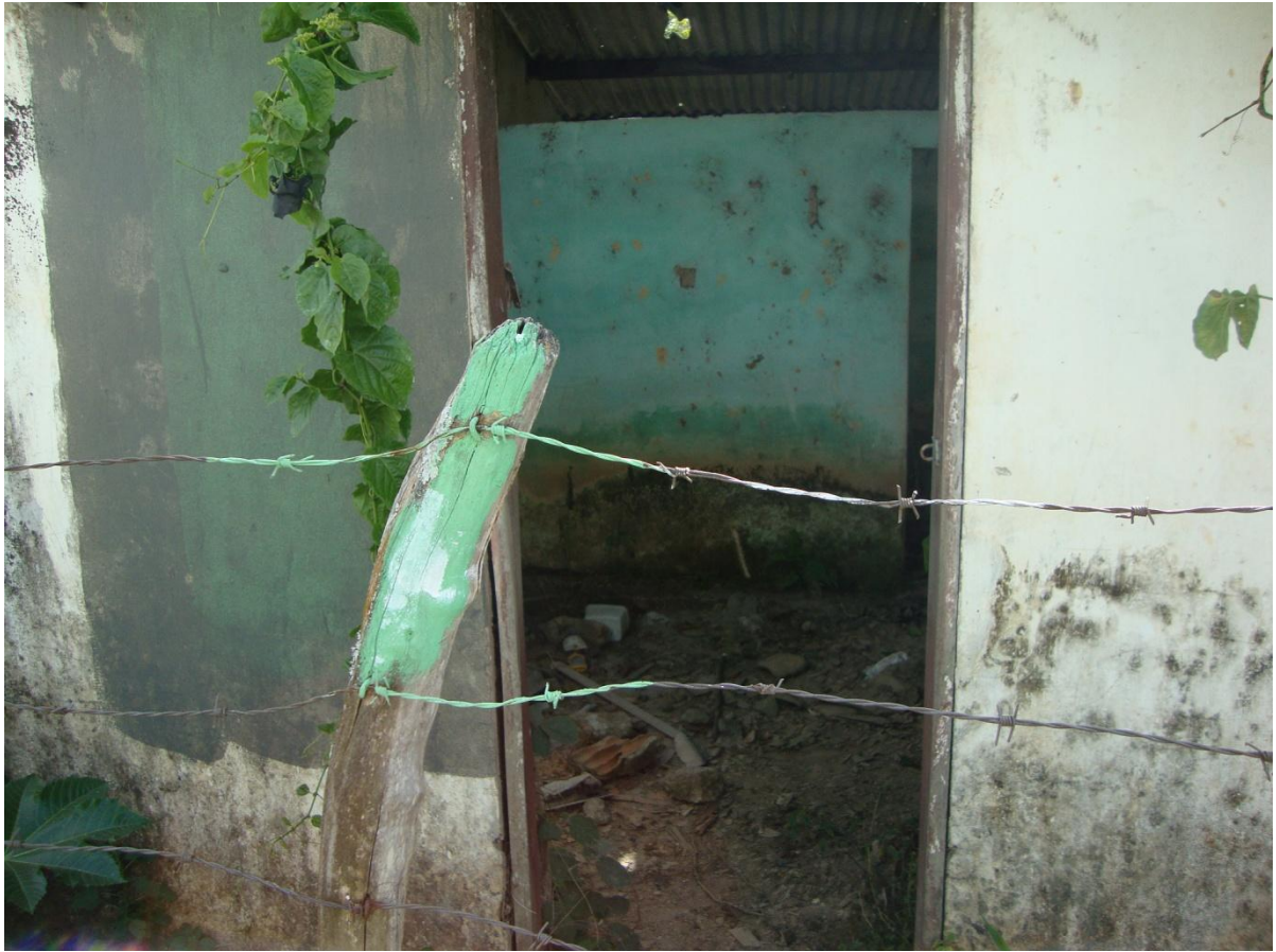
Marca de inundação em residência próxima ao Córrego Pedra Branca
