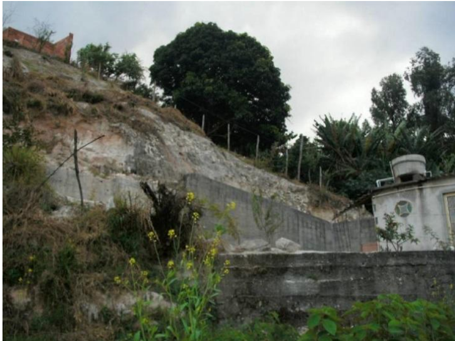
Encosta com risco de deslizamento no Bairro São Geraldo
