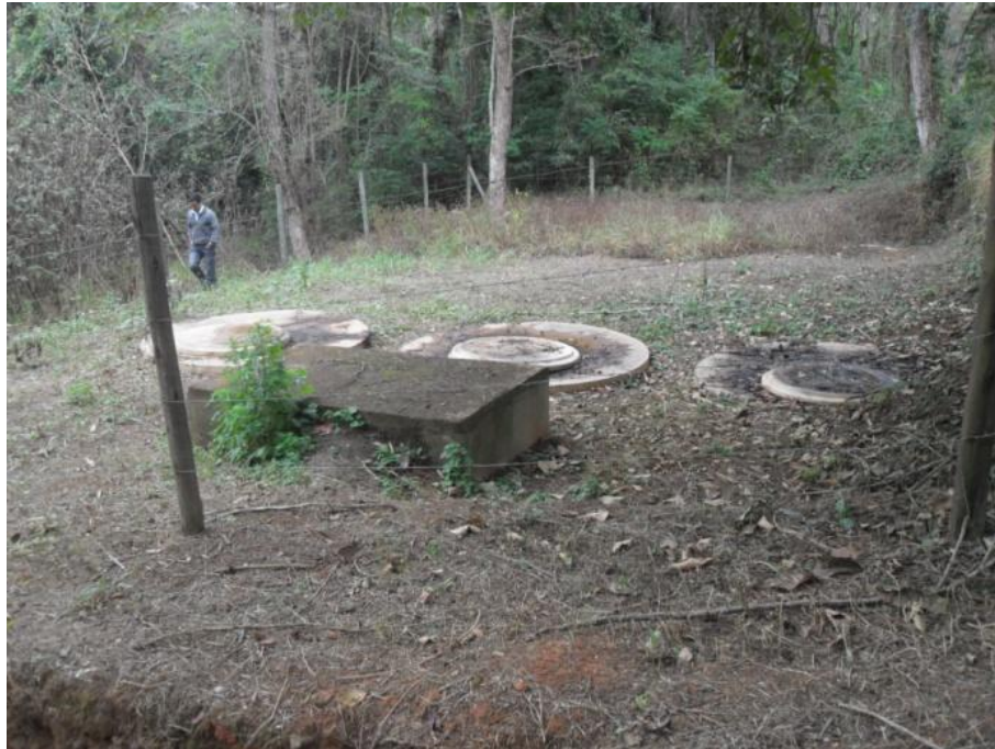
Figura 7.90 - Detalhe da ETE fossa-filtro de Roças Novas
