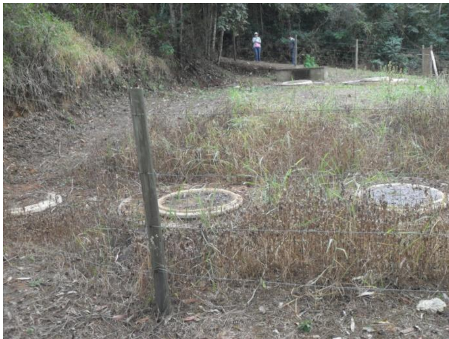
Figura 7.89 - Área da ETE fossa-filtro de Roças Novas
