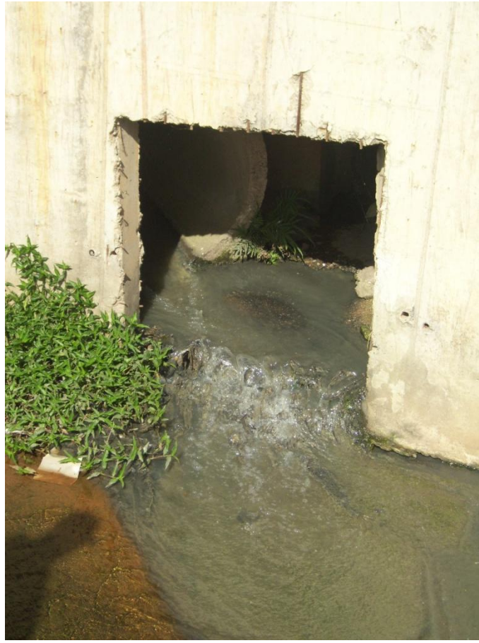
Lançamento de esgotos no Córrego Caeté
