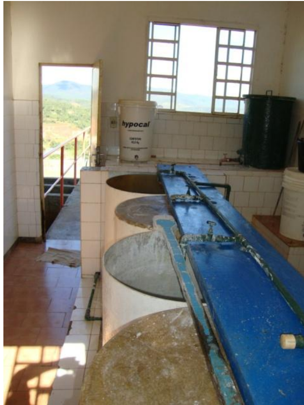
Figura 7.66 - Tanque de mistura de produtos químicos
