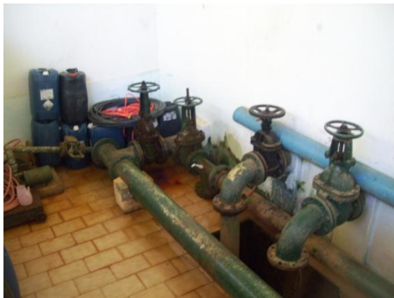
Figura 7.67 – Registros para controle da vazão
