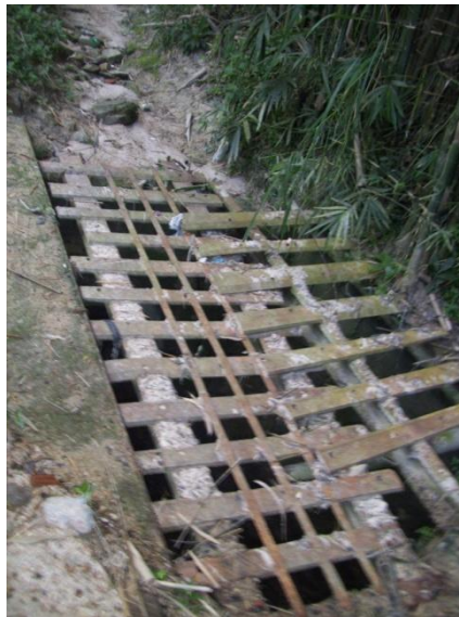
Ponto de alagamento na Vila Rato
