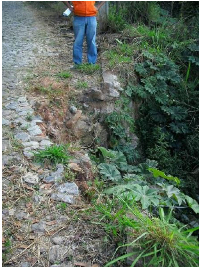
Foco de deslizamento na área urbana do Centro Histórico
