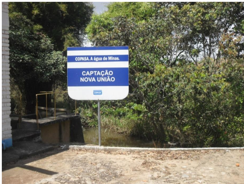
Figura 7.50 - Placa de identificação da captação superficial no córrego dos Lopes
