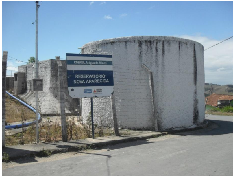
Figura 7.62 – Reservatórios em Nova Aparecida
