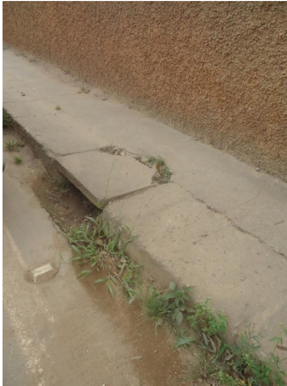
Figura 7.125 - Boca-de-lobo na sede municipal
