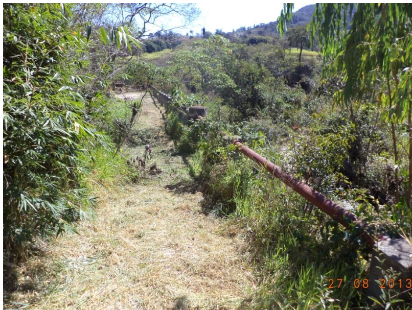
Figura 7.85 - Rede que conduz o esgoto à ETE Nova Esperança
