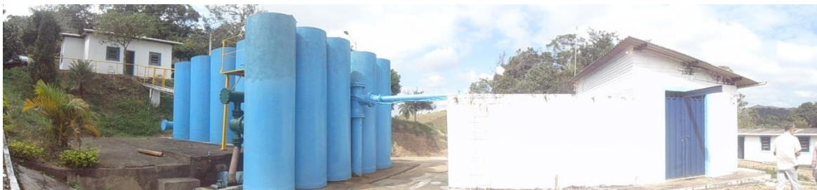
Figura 7.57 - Visão geral da ETA Nova União
