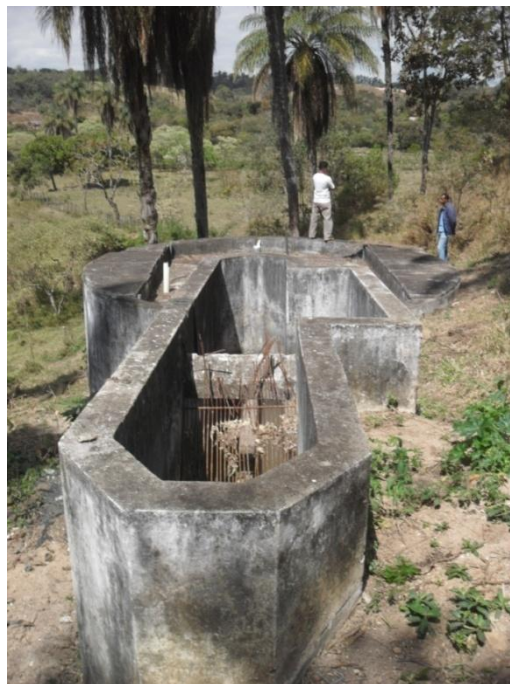
Figura 7.92 - Tratamento preliminar da ETE Nova Aparecida
