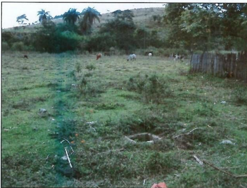
Figura 4.3 – Caixas de Coleta de Esgotos Atrás das Casas da Rua José Nestor
