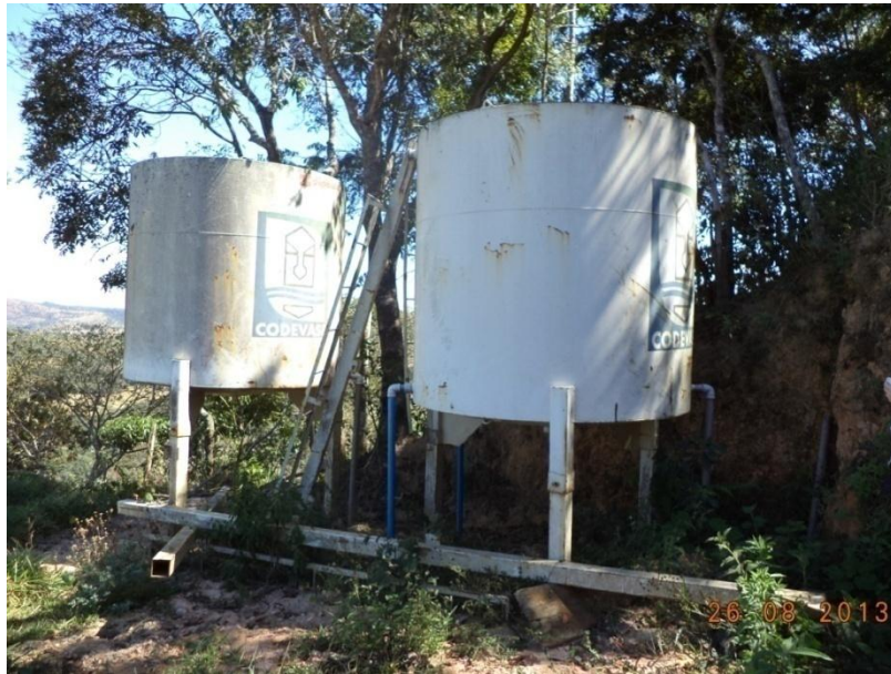
Figura 7.68 – Reservatórios de Monte Horeb
