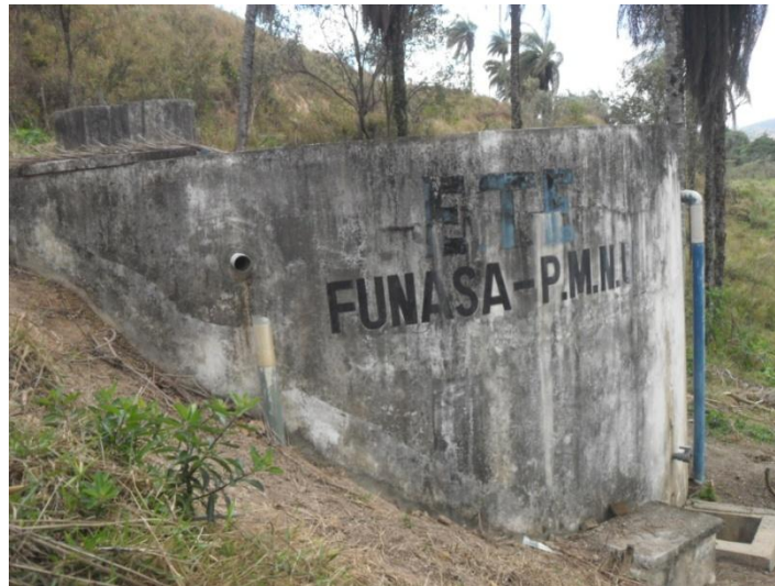
Figura 7.91 - Reator anaeróbio da ETE Nova Aparecida
