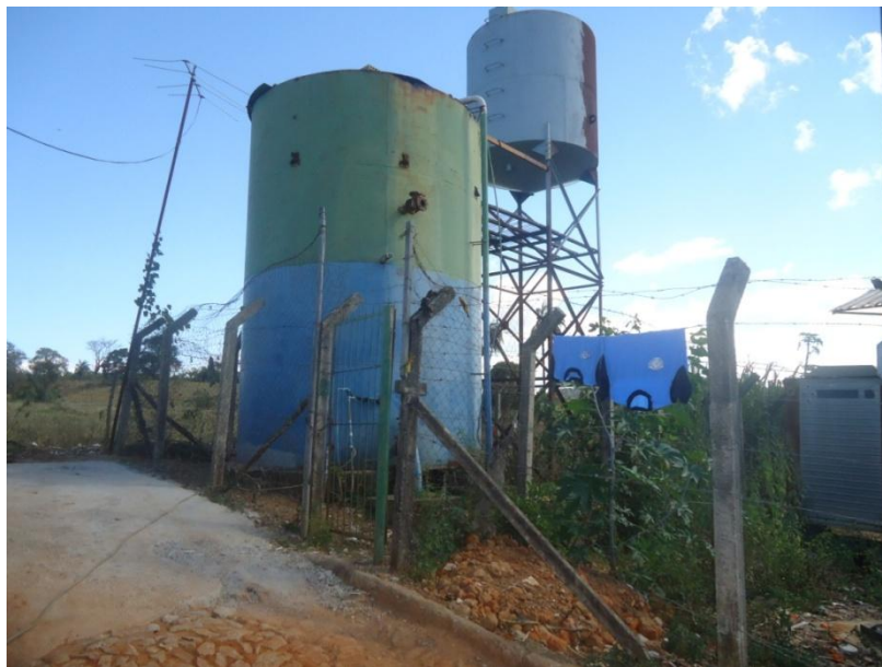
Figura 7.71 – Reservatórios de Carmo de União
