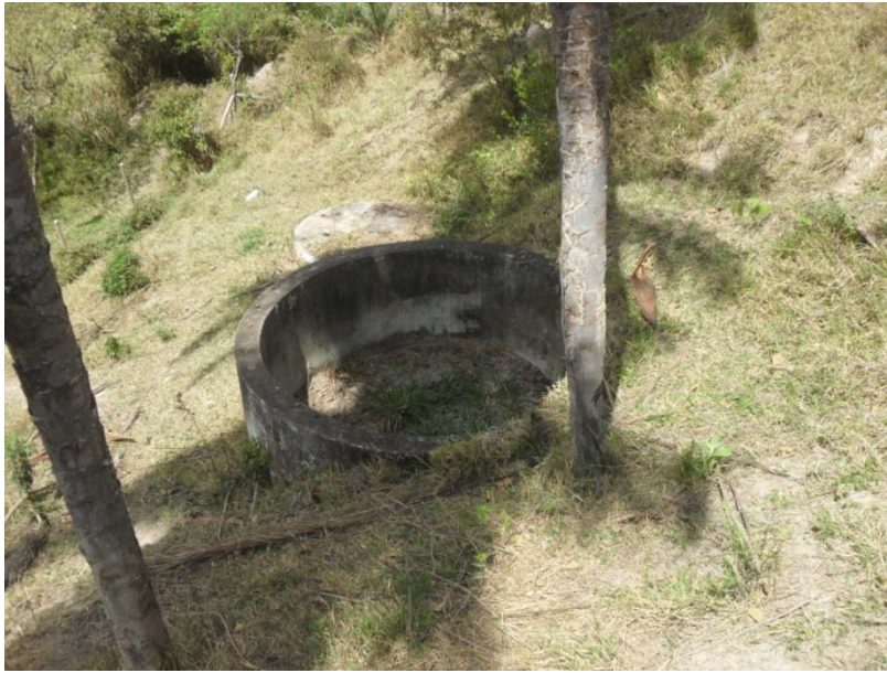
Figura 7.93 - Leito de secagem de lodo da ETE Nova Aparecida
