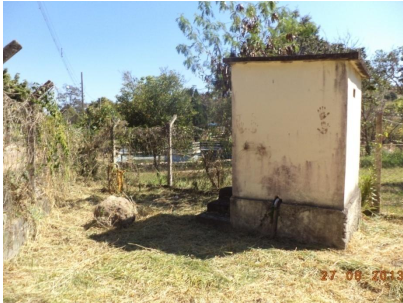
Figura 7.74 – Poço artesiano do Lopes
