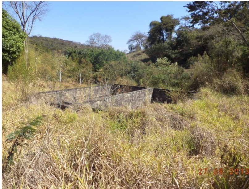
Figura 7.84 - Leitões de secagem de lodo da ETE Nova Esperança
