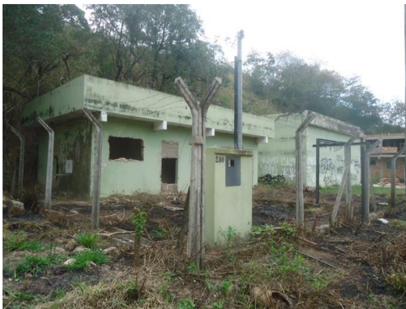
Figura 7-113 – Vista da ETE Nações Unidas depredada e abandonada
