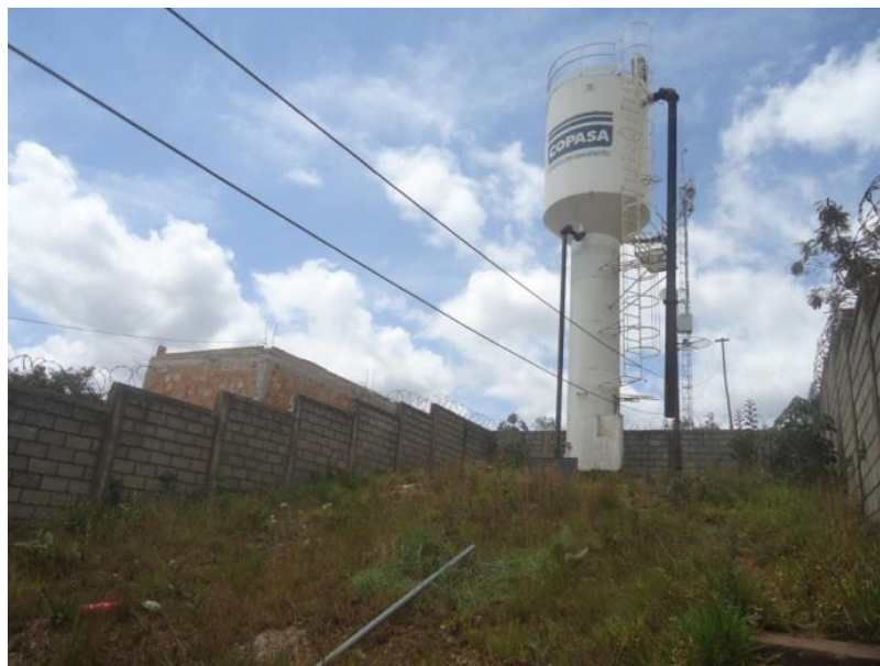
Figura 7-65 – Reservatório Elevado Rosário (COPASA): Regional Santo Antônio das Roças Grandes Fonte: COBRAPE (2013).
