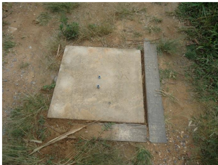
Figura 7-90 – Poço artesiano Várzea dos Crioulos
