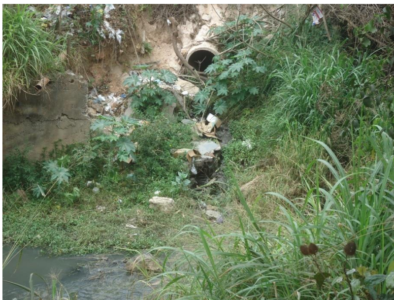
Figura 7-112 – Lançamento de esgoto no córrego Malheiros, próximo ao bairro Nações Unidas Fonte: COBRAPE (2013).
