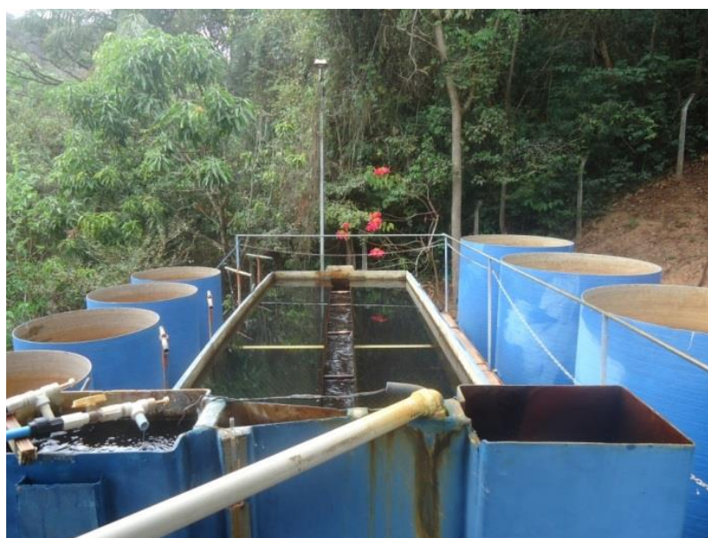
Figura 7-80 – Tratamento de água – Ravena
