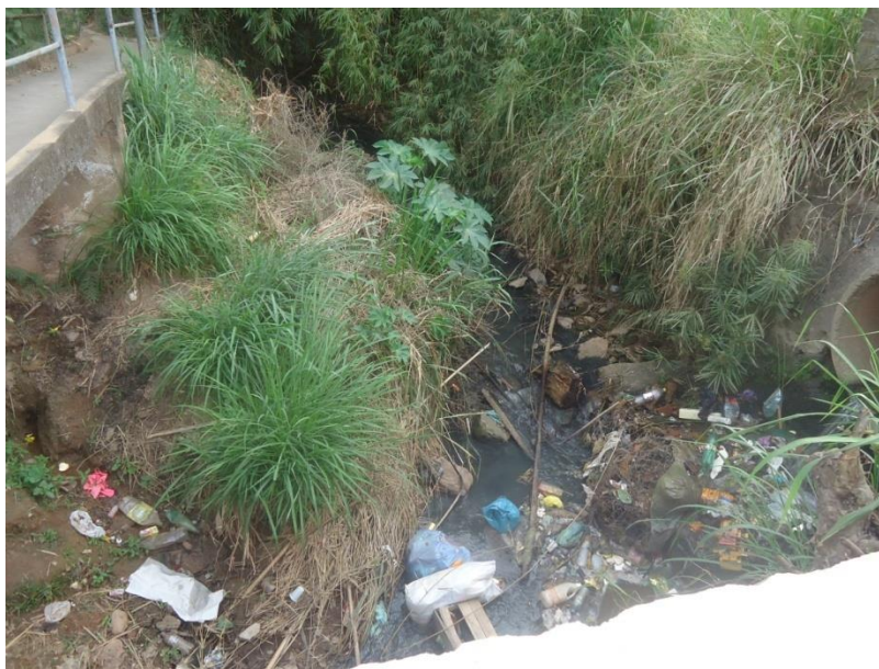
Figura 7-117 – Degradação do corpo d’água com lançamento de esgoto in natura
