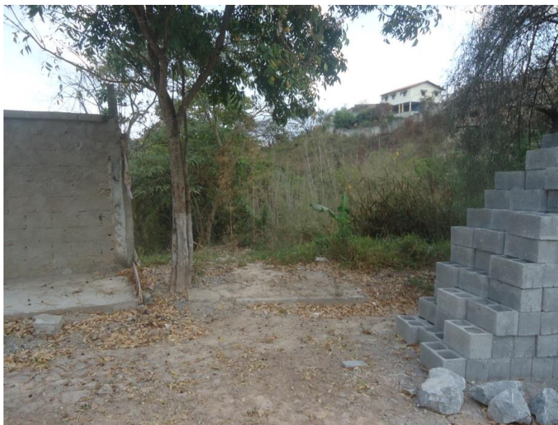
Figura 7-104 – Acesso a ETE Vila Real II inoperante
