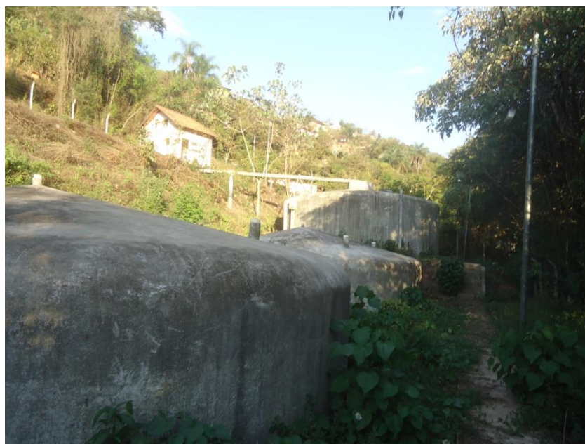
Figura 7-102 – Vista das unidades construídas da ETE Adelmolândia inoperante
