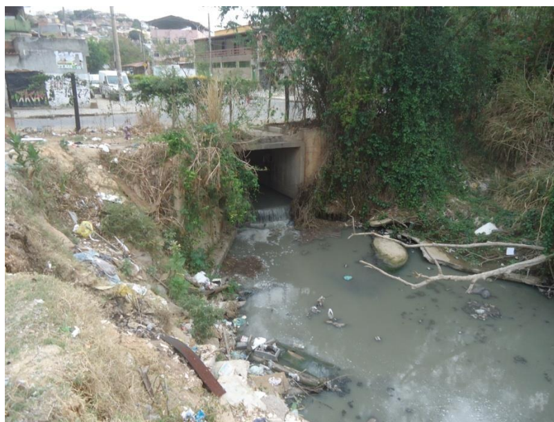
Figura 7-106 – Lançamento de esgotos no córrego Malheiros
