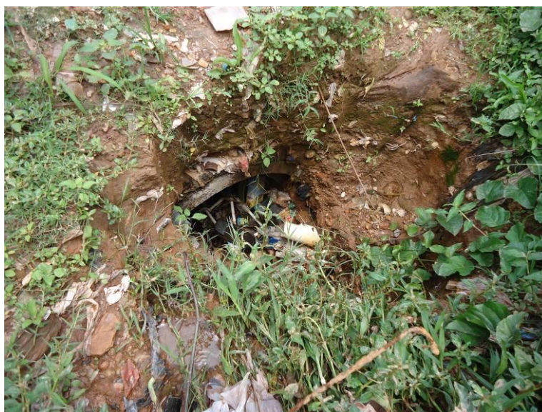
Figura 7-155 - Galeria de drenagem de águas pluviais obstruída por resíduos.
