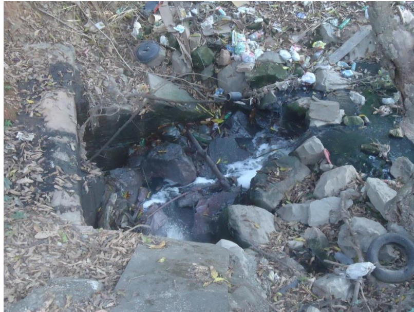
Figura 7-114 – Ponto de lançamento de esgotos no rio das Velhas (parte dos efluentes são provenientes de Sabará e de Belo Horizonte)
