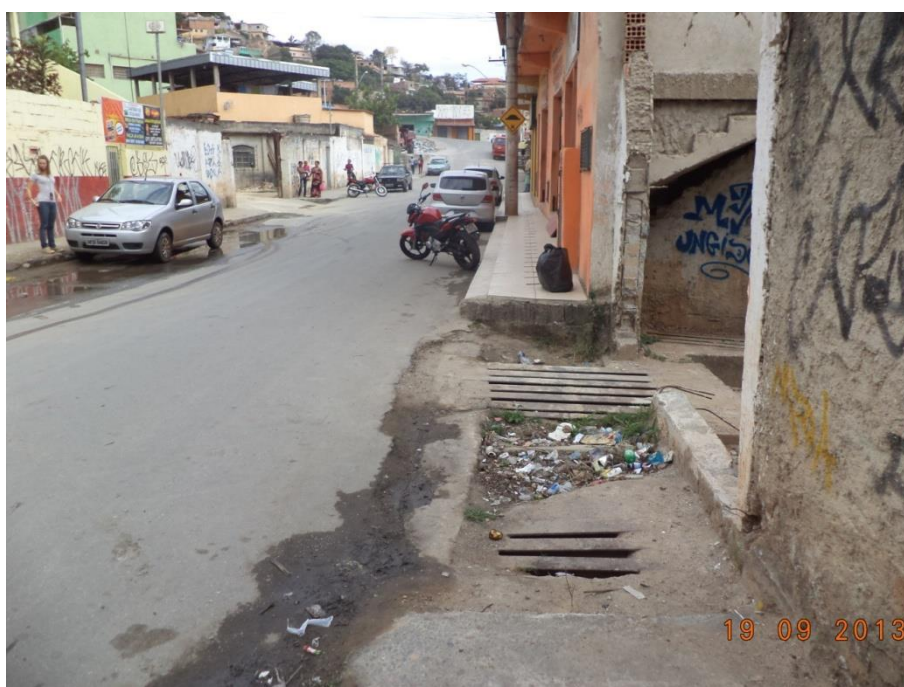
Figura 7-195 – Grelha de captação da galeria da Rua Montes Claros
