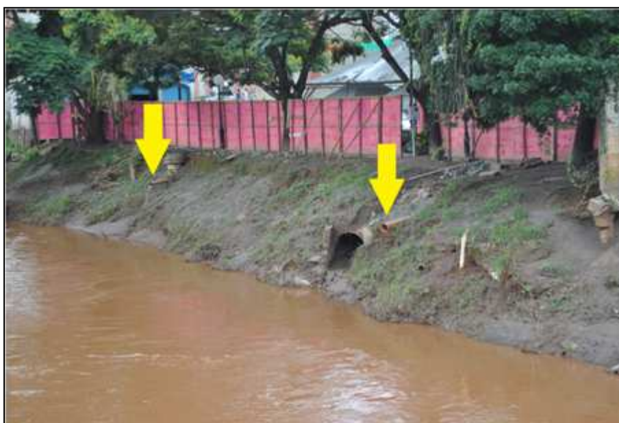
Figura 30. Lançamento Irregular de Esgoto no Rio Itabirito (Destaque para as Canalizações)
