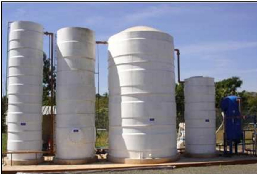
Figura 54. Estação Compacta de Tratamento de Esgoto Sanitário Fonte: DRZ Geotecnologia e Consultoria
