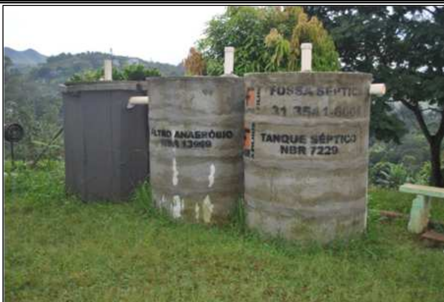
Figura 159. Fossa Séptica no Povoado de Ribeirão do Eixo
