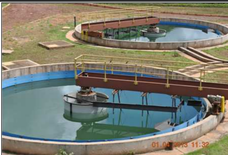
Figura 42. Decantadores da ETE Fonte: DRZ Geotecnologia e Consultoria (2013)
