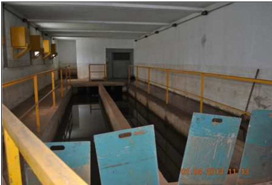
Figura 33. Caixa de Areia da EEE Fonte: DRZ Geotecnologia e Consultoria (2013)
