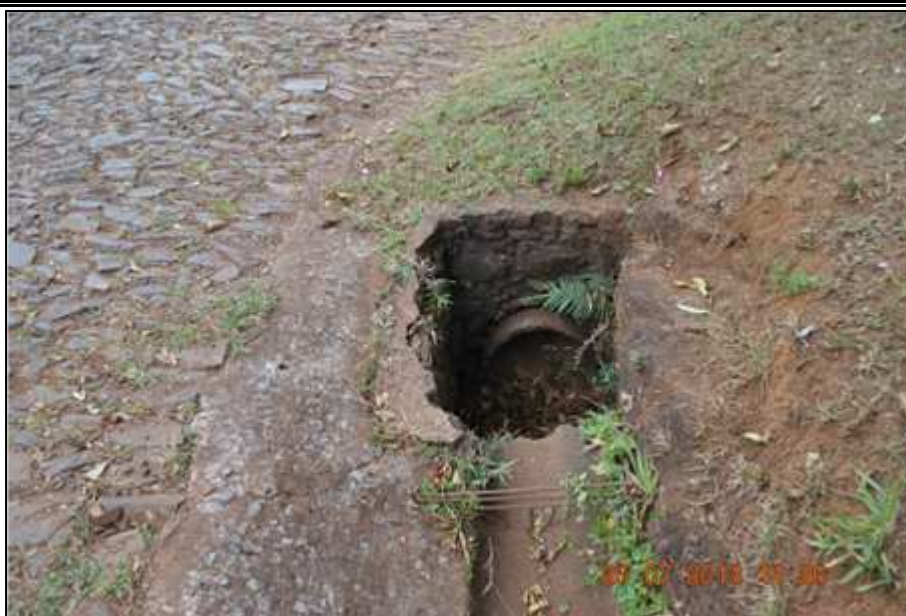
Figura 180. Tubulação para Transporte das Águas Pluviais do Condomínio Aconchego da Serra
