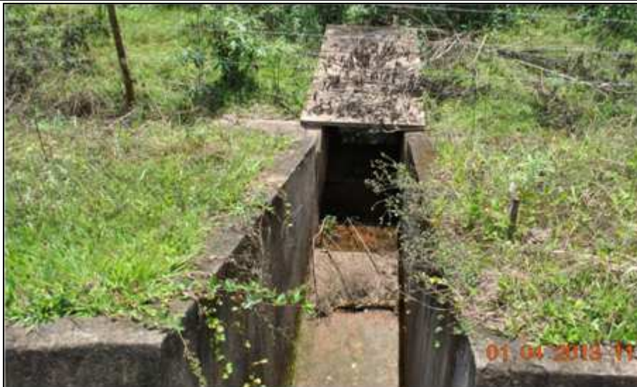
Figura 44. Emissário Final da ETE de Lançamento de Efluentes no Rio Itabirito Fonte: DRZ Geotecnologia e Consultoria (2013)
