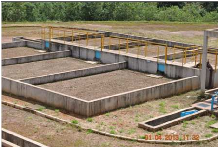
Figura 45. Leitos de Secagem de Lodo da ETE Fonte: DRZ Geotecnologia e Consultoria (2013)
