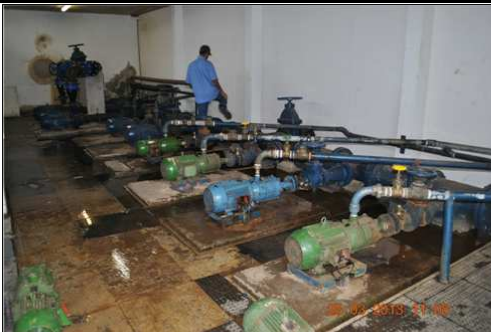
Figura 22. Estação Elevatória que Bombeia a Água Tratada da ETA da Sede para o Sistema Woods Soares, além dos Bairros Munu e Primavera
