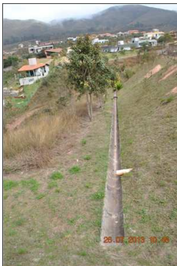
Figura 173. Dispositivo de Drenagem de Águas Pluviais no Condomínio Villa Bella Fonte: DRZ Geotecnologia e Consultoria (2013)
