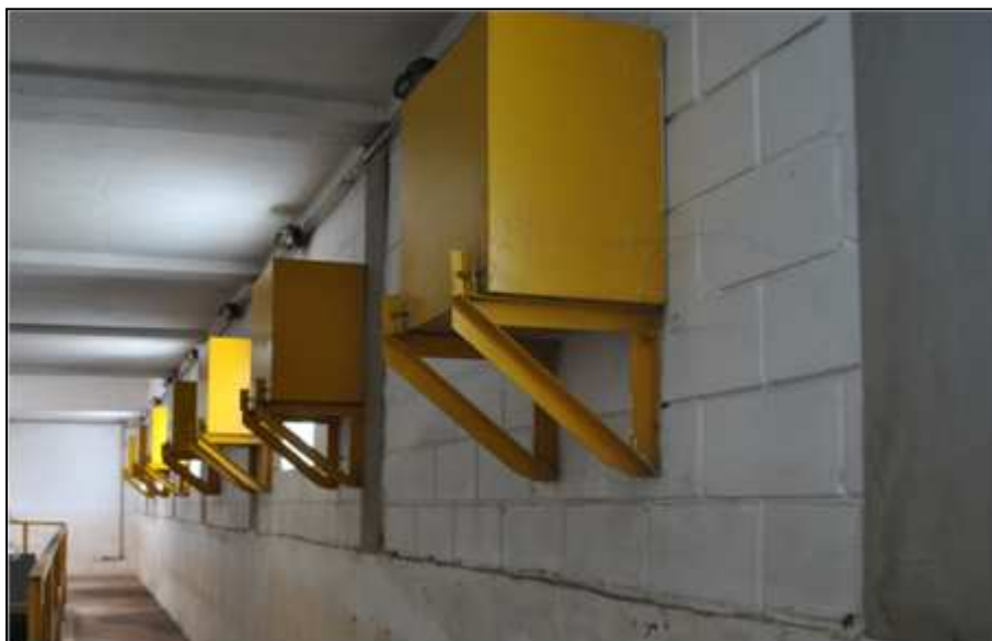
Figura 35. Sistema de Exaustão da EEE Fonte: DRZ Geotecnologia e Consultoria (2013)
