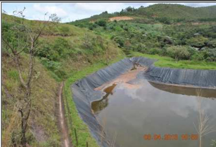
Figura 82. Calha Pluvial e Lagoa de Tratamento de Chorume
