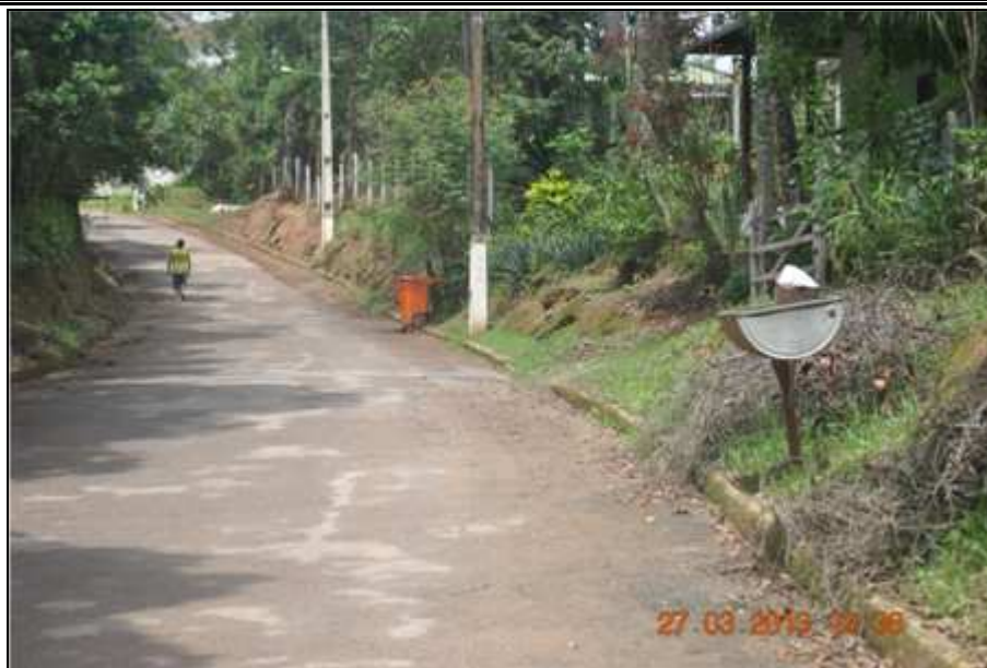
Figura 137. Falta de Microdrenagem no Distrito de Acuruí
