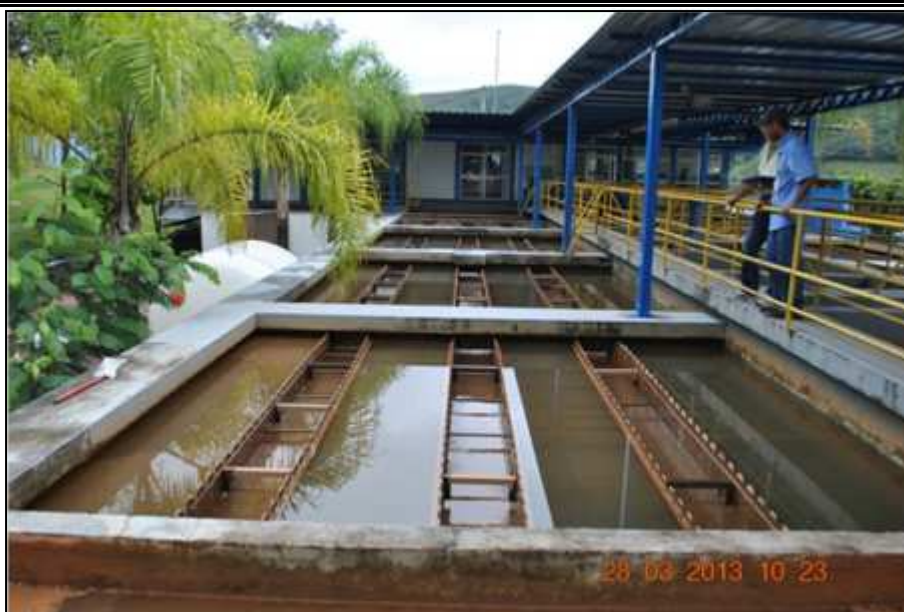
Figura 18. Decantador Fonte: DRZ Geotecnologia e Consultoria (2013)
