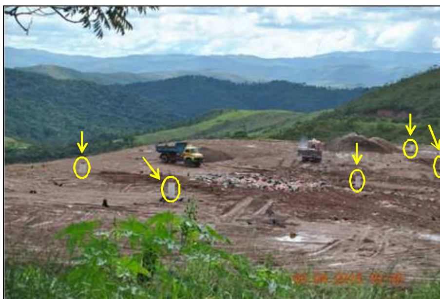
Figura 80. Célula do Aterro com Tambores de Queima de Gases Fonte: DRZ Geotecnologia e Consultoria (2013)
