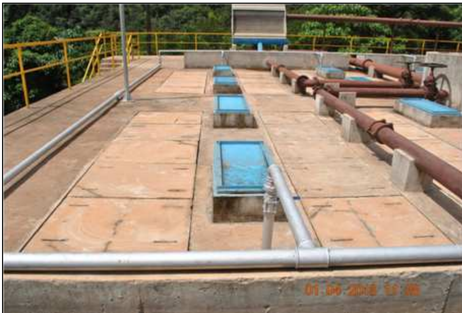
Figura 39. Reatores Anaeróbios de Manta de Lodo (UASB) Fonte: DRZ Geotecnologia e Consultoria (2013)
