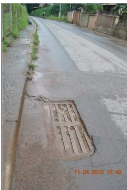
Figura 125. Microdrenagem Obstruída com Resíduos Fonte: DRZ Geotecnologia e Consultoria (2013)
