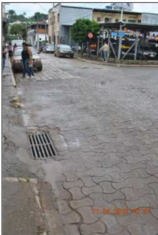
Figura 119. Microdrenagem em Via Transversal da Área Central de Itabirito Fonte: DRZ Geotecnologia e Consultoria (2013)
