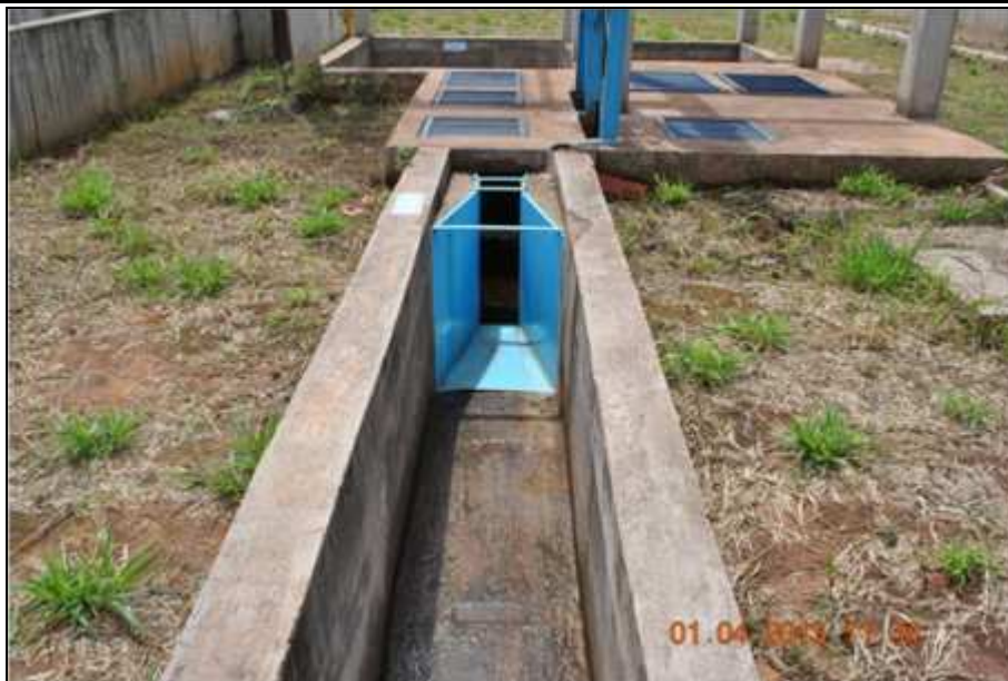
Figura 34. Calha Parshall da Estação Elevatória de Esgoto Fonte: DRZ Geotecnologia e Consultoria (2013)
