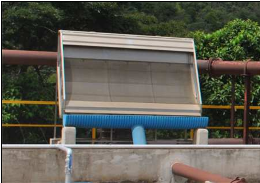
Figura 38. Peneiras Estáticas da ETE Fonte: DRZ Geotecnologia e Consultoria (2013)
