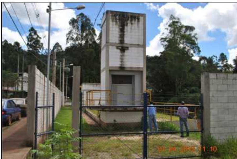
Figura 31. EEE do Sistema de Tratamento de Esgoto da Sede do Município de Itabirito Fonte: DRZ Geotecnologia e Consultoria (2013)
