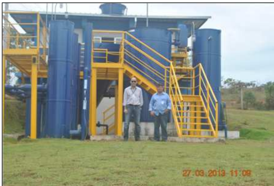
Figura 129. ETA Compacta de Acuruí Fonte: DRZ Geotecnologia e Consultoria (2013)
