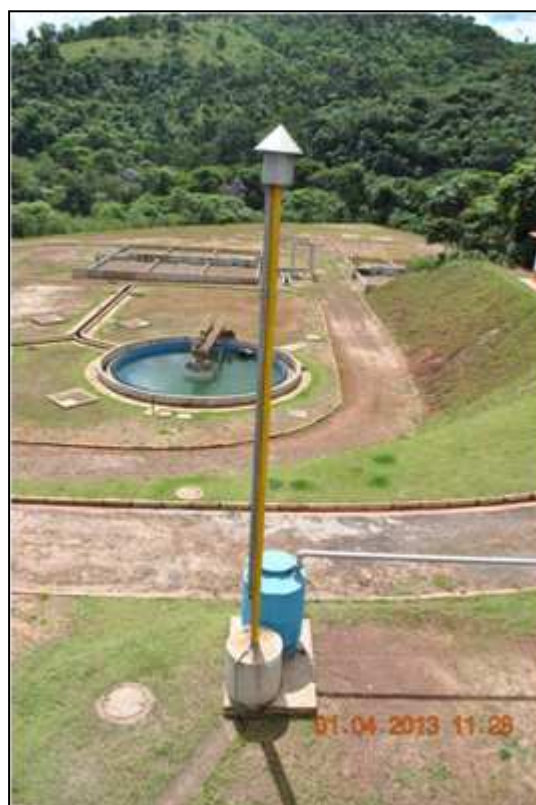
Figura 47. Queimador de Gases da ETE Fonte: DRZ Geotecnologia e Consultoria (2013)
