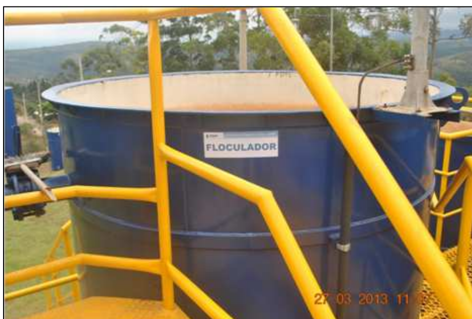
Figura 132. Floculador Fonte: DRZ Geotecnologia e Consultoria (2013)
