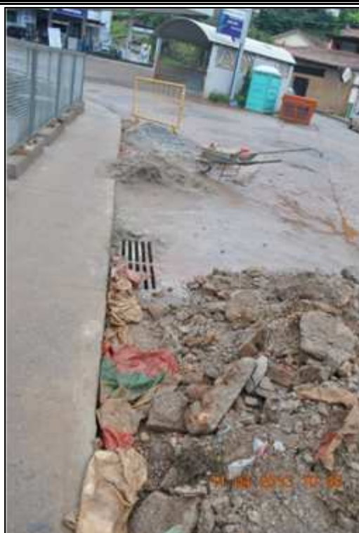
Figura 124. Resíduos de Construção Civil Próximos à Microdrenagem Fonte: DRZ Geotecnologia e Consultoria (2013)
