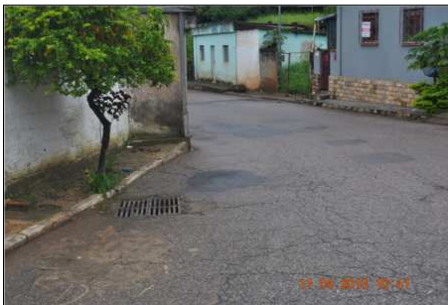
Figura 121. Rua com Ausência de Abulamento Fonte: DRZ Geotecnologia e Consultoria (2013)
