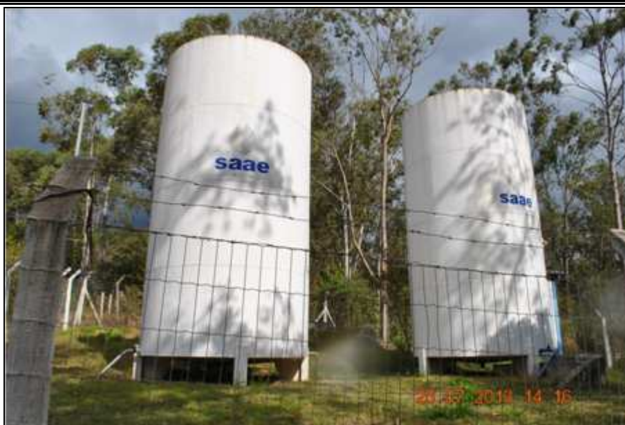
Figura 142. Reservatórios do SAAE de São Gonçalo do Bação
