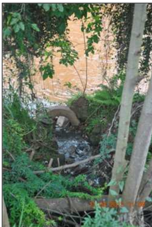
Figura 49. Emissário Final de Esgoto no Rio Itabirito Fonte: DRZ Geotecnologia e Consultoria (2013)
