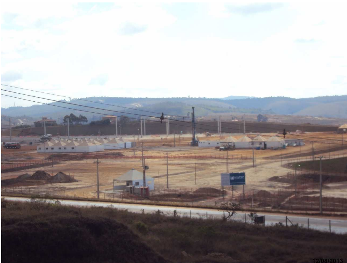
Figura 23 - Obras da empresa Coca-Cola Femsa em Itabirito Fonte: DRZ Geotecnologia e Consultoria (2013)
