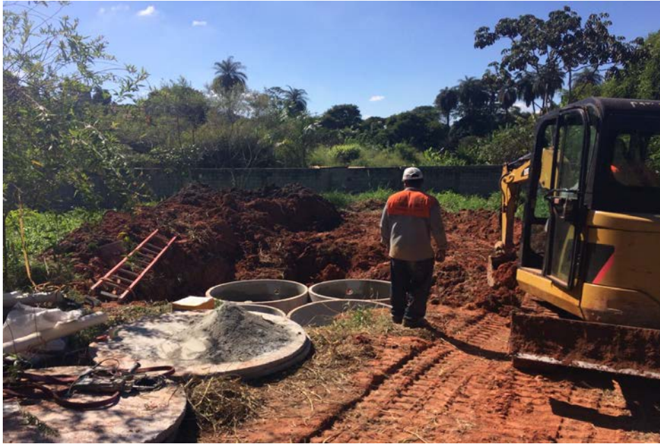
Figura 32 – Construção das fossas Sépticas com filtro anaeróbico na área da Nascente - Fonte: Gos Florestal
