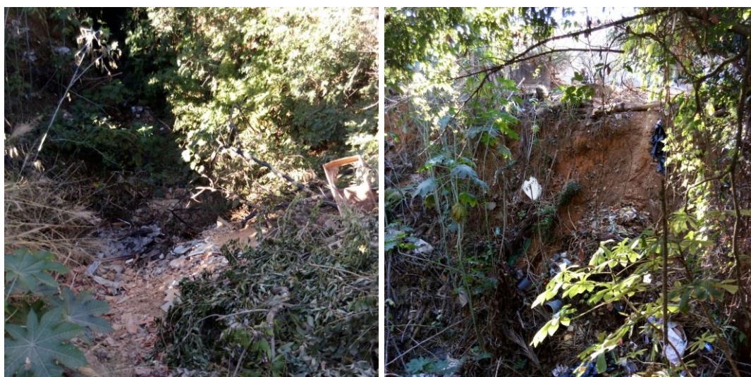
Figura 3.2 e Figura 3.3 – Local do lançamento do bueiro do fundo de vale da Rua das Acácias.
