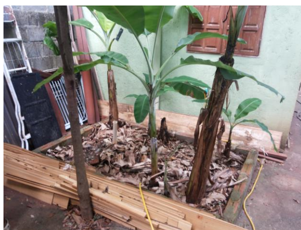
Figura 3.8 — T.Evap em funcionamento com plantio de bananeiras e tubo de inspeção Local: Refúgio São Francisco, Serra do Cipó, Santana do Riacho, MG.
