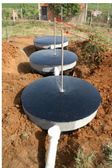
Figura 3.13 – Fossa Séptica Biodigestora instalada.
