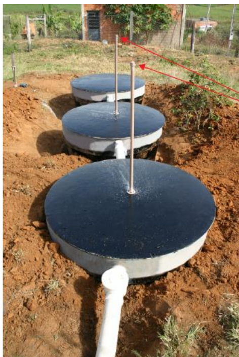
Figura 4.12 – Fossa Séptica Biodigestora instalada.
