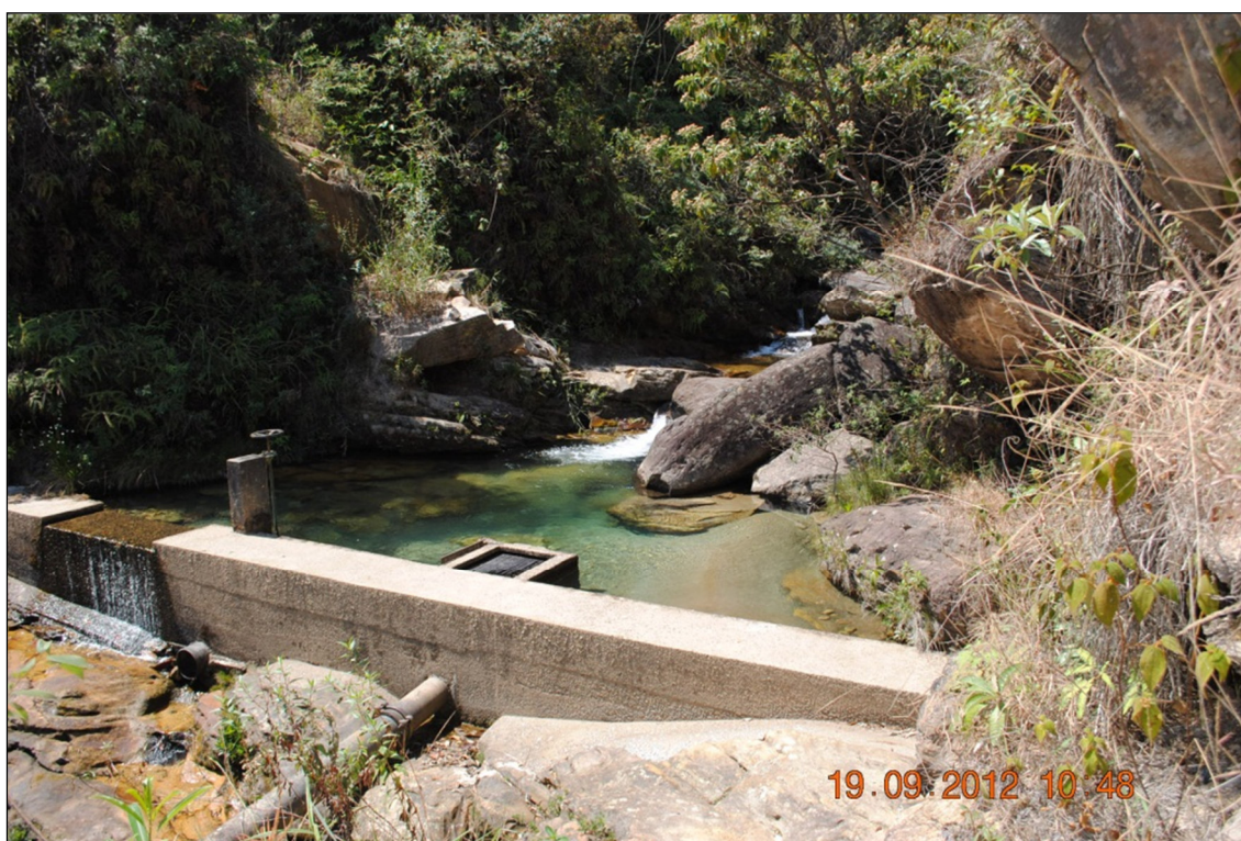
Figura 29. Captação da ETA Itacolomi no córrego Teixeira.
