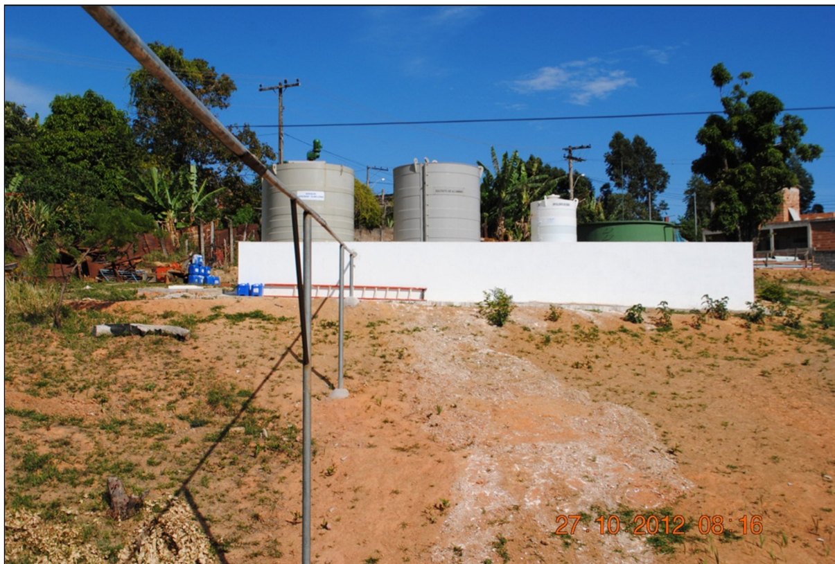
Figura 44. Novo sistema de armazenamento de produtos químicos da ETA Vila Alegre.
