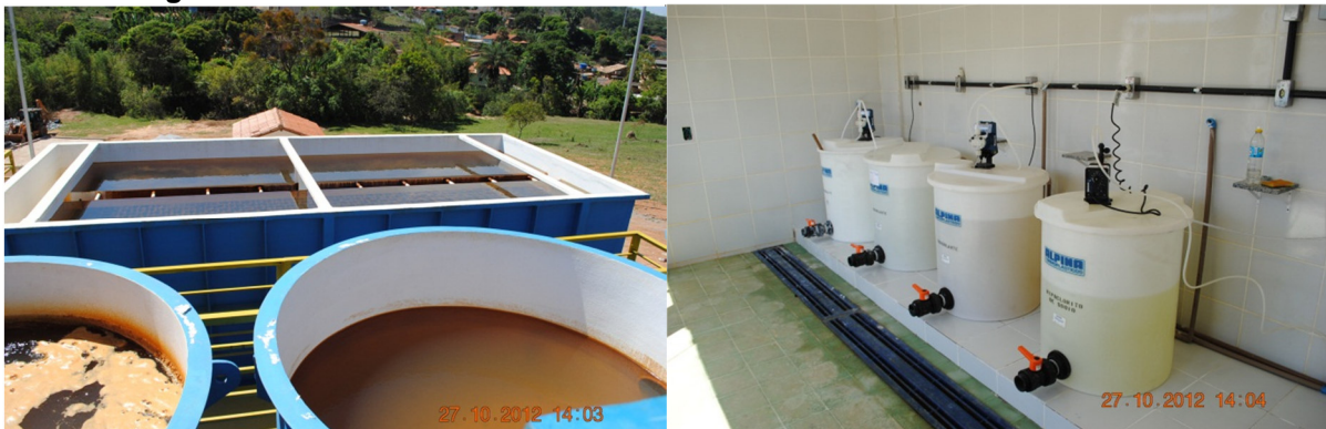
Figura 61. Floculadores e decantadores e dosadores da ETA de Amarantina.
