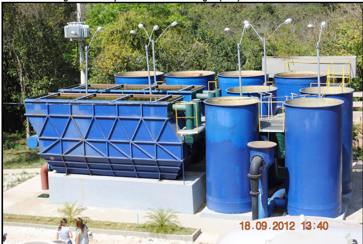
Figura 41. Estação de Tratamento de Água (ETA) Jardim Botânico.
