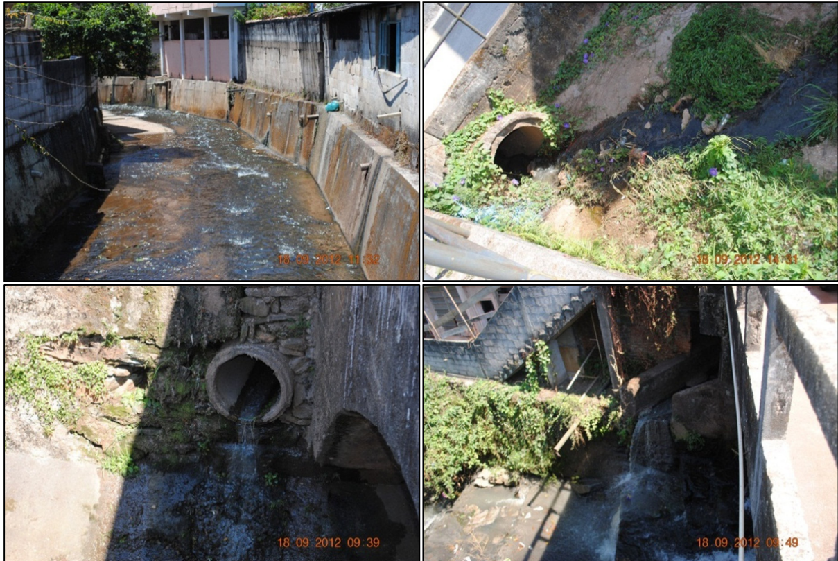
Figura 86. Pontos de lançamentos de esgoto nos córregos Caquende, Sobreiro, Contos e Funil.
