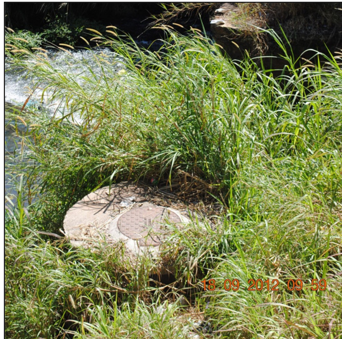
Figura 85. Início do emissário de esgoto do córrego Funil no bairro Barra – sede de Ouro Preto.
