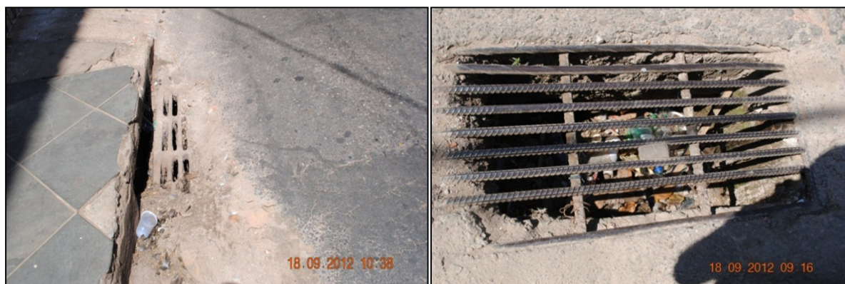
Figura 121. Entupimento de bocas de lobo da Rua Paulo Magalhães Gomes e rua José Anastácio.
