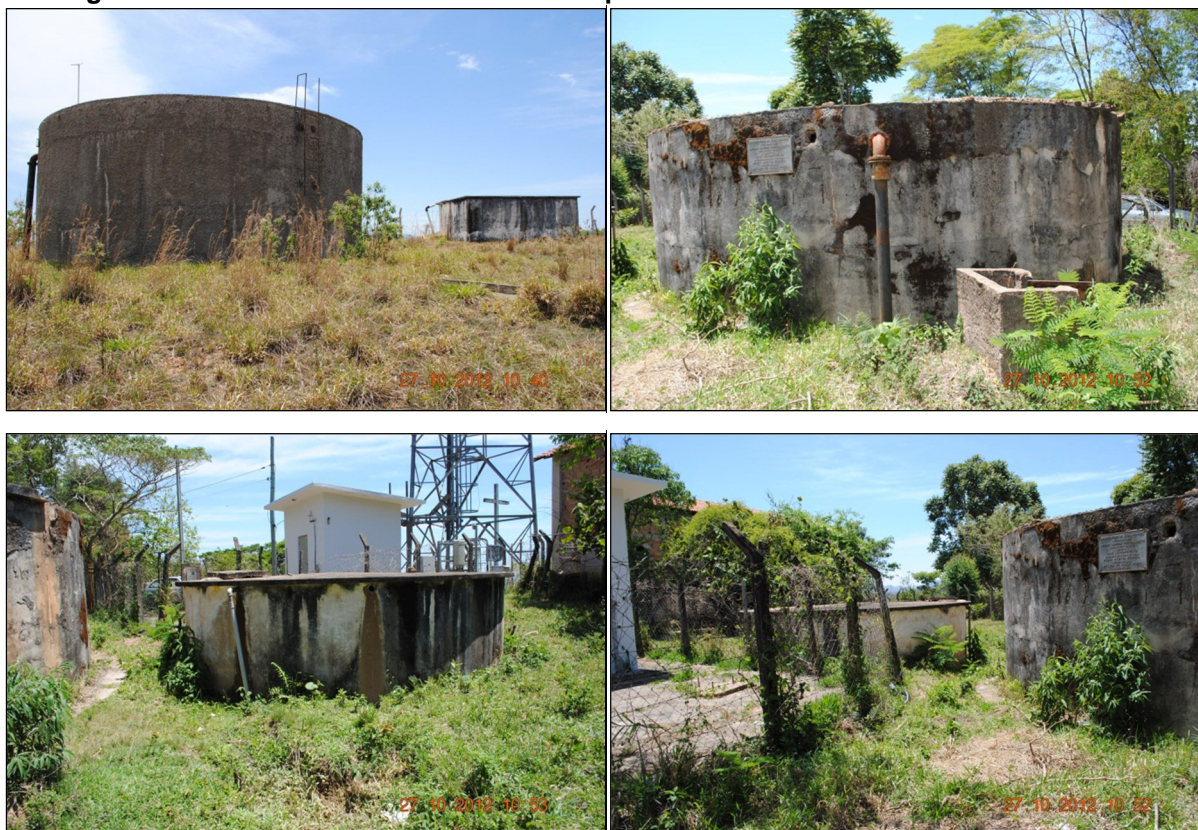
Figura 72. Reservatórios de Gouveia e Chapada no Distrito de Santo Antônio do Leite.
