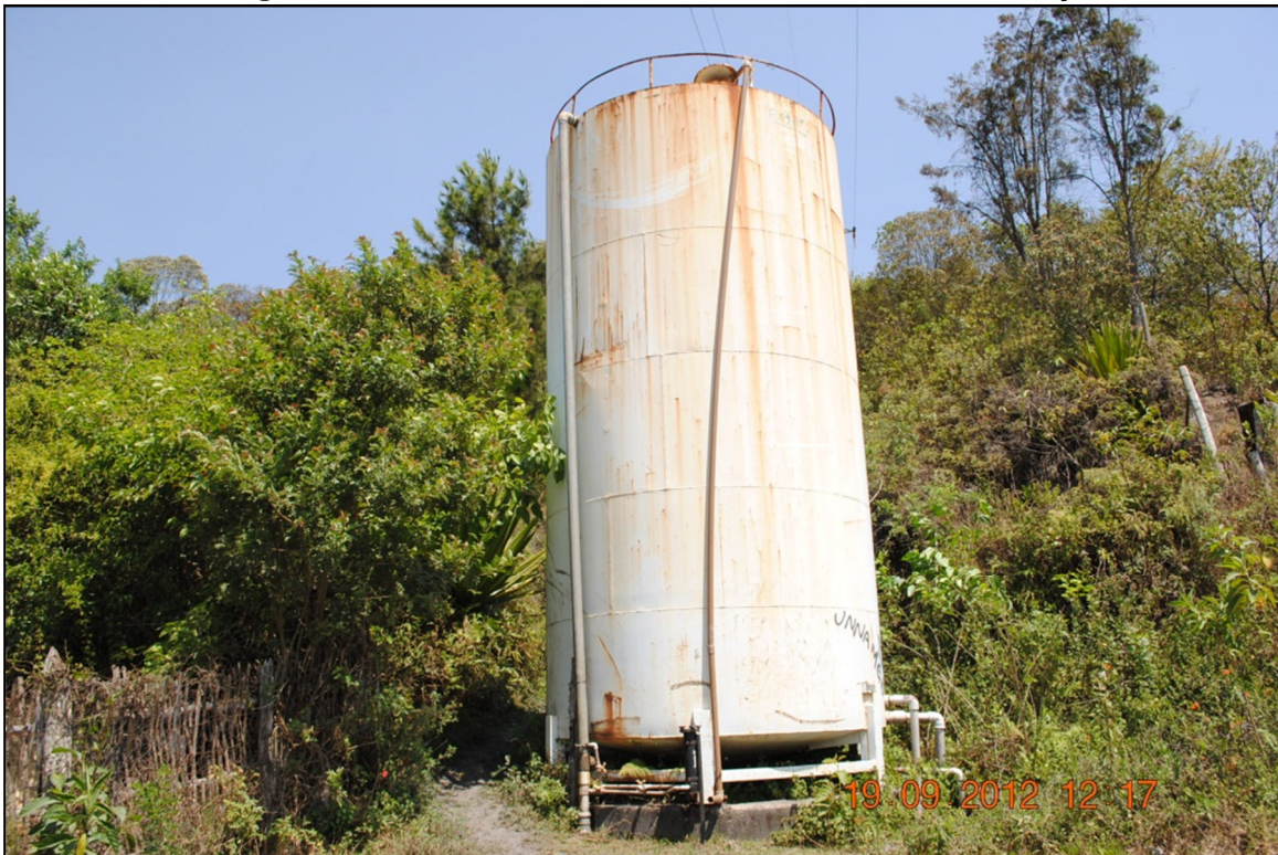
Figura 38. Reservatório Saramenha II com sistema de cloração
