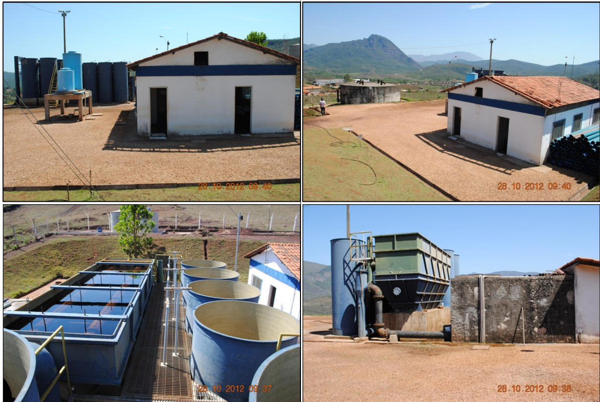
Figura 57. ETA Antônio Pereira.
