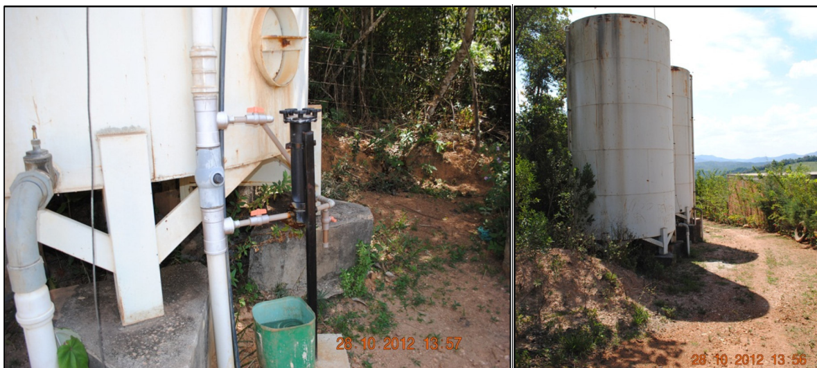
Figura 75 - Reservatórios de metal apoiado e cloração.
