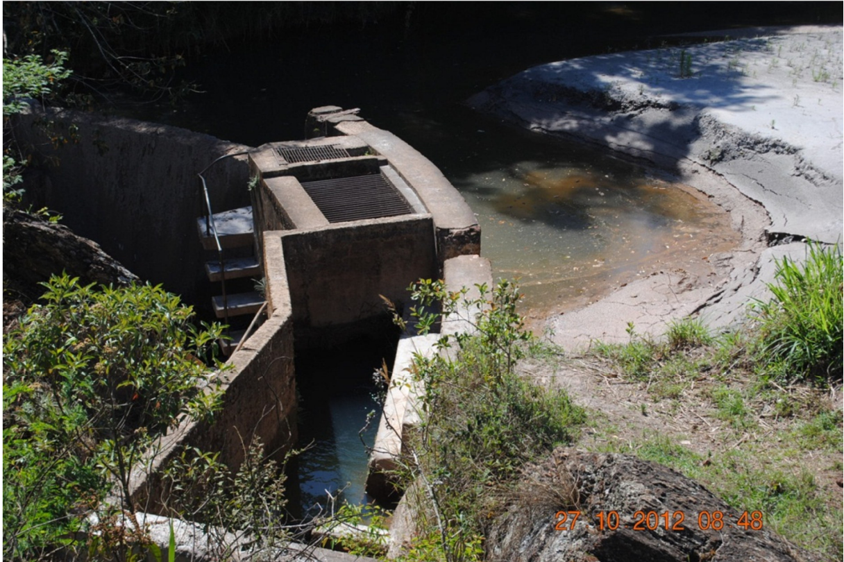
Figura 42. Captação ETA Vila Alegre no Córrego Maracujá – Cachoeira do Campo.
