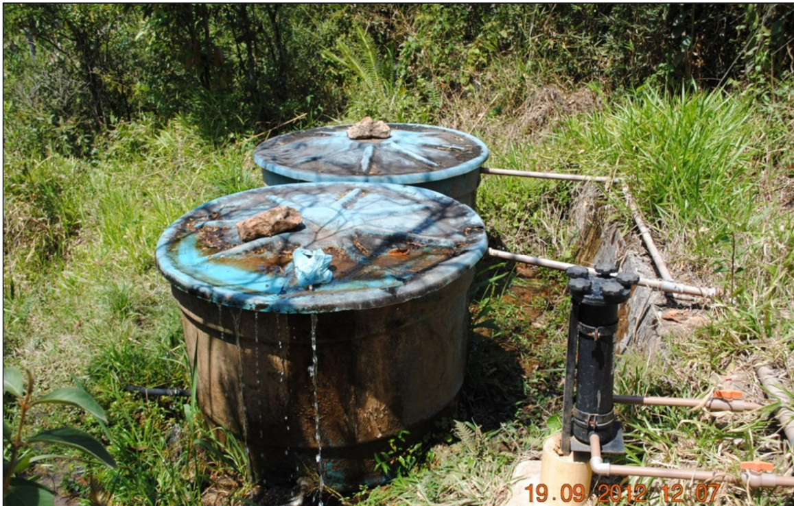
Figura 37. Reservatório Saramenha III com sistema de cloração.
