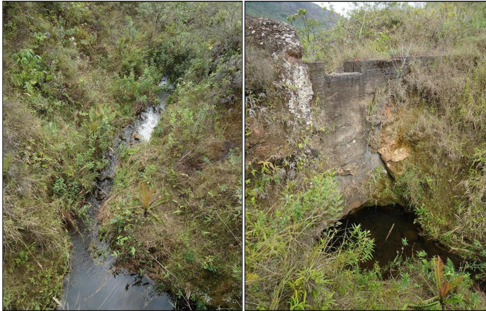
Figura 54. Nova captação localizada no afluente do córrego Água Suja.
