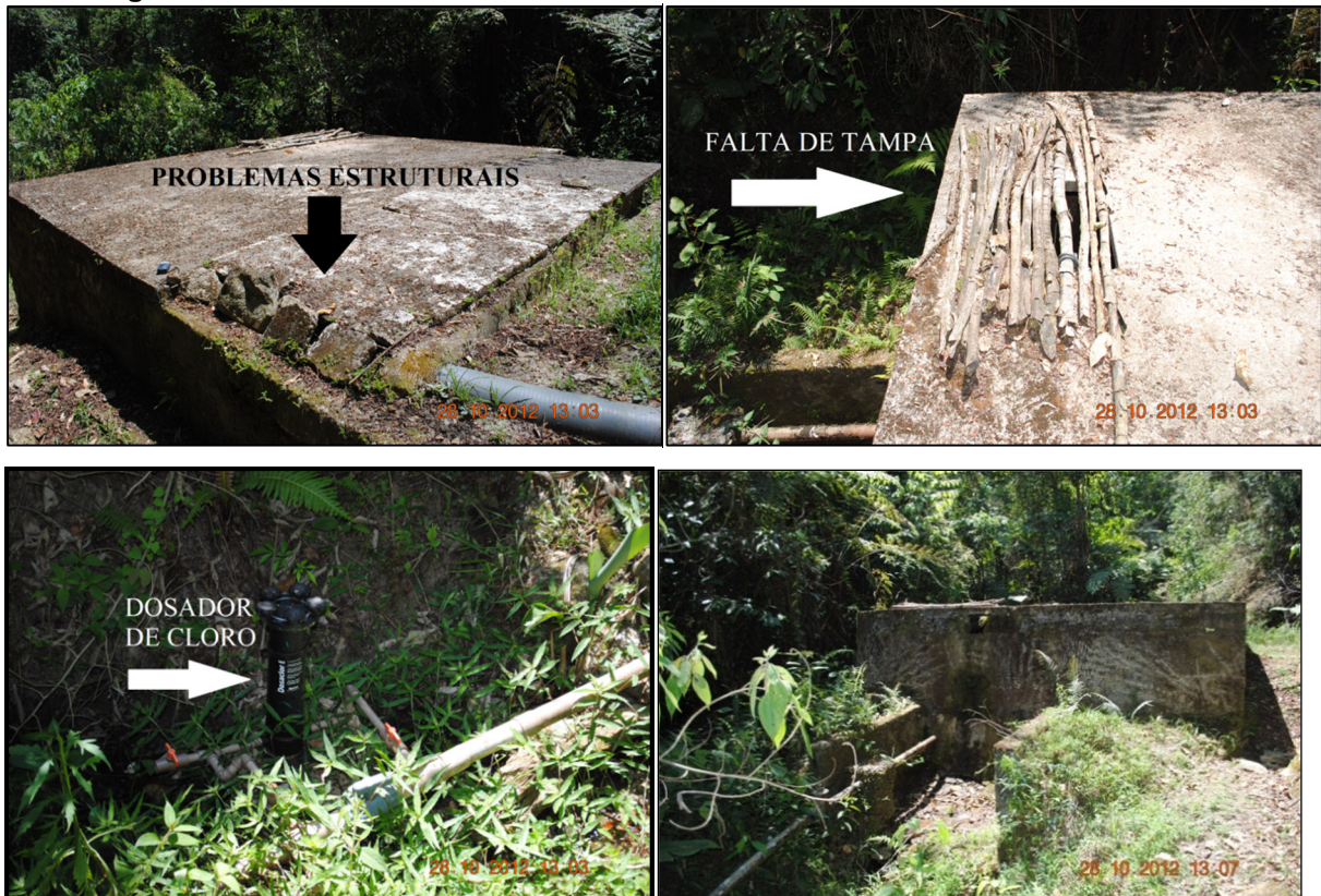
Figura 73. Reservatório da Fazenda Soares do distrito de Santo Antônio do Salto.
