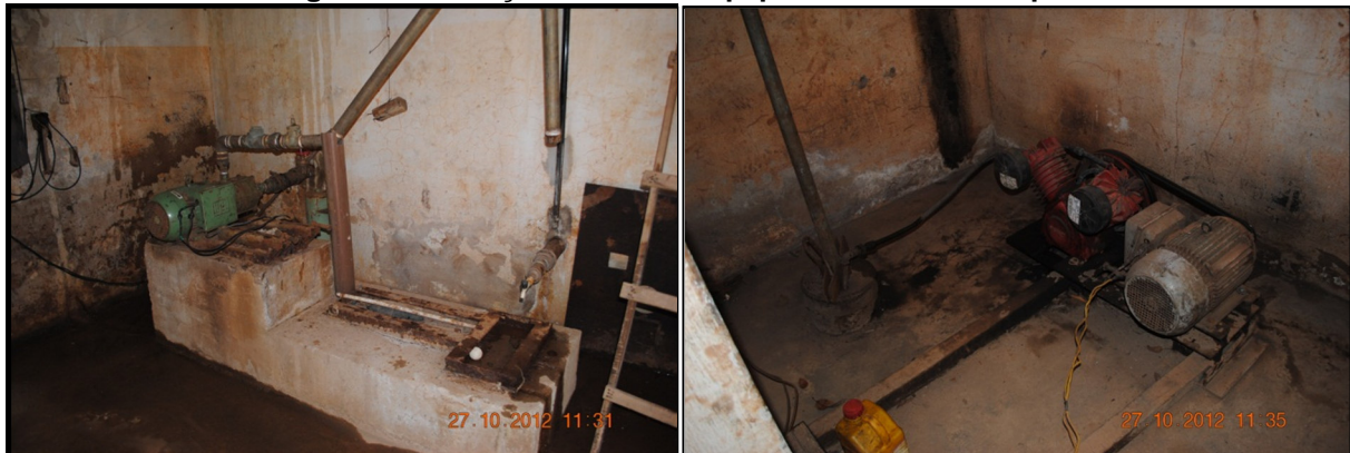
Figura 67. Situação atual dos equipamentos de recalque.
