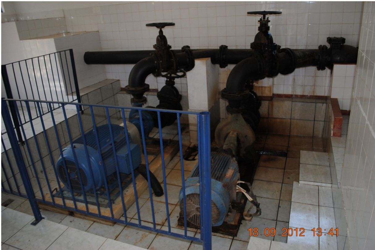
Figura 40. Conjunto moto bomba para adução de água bruta.
