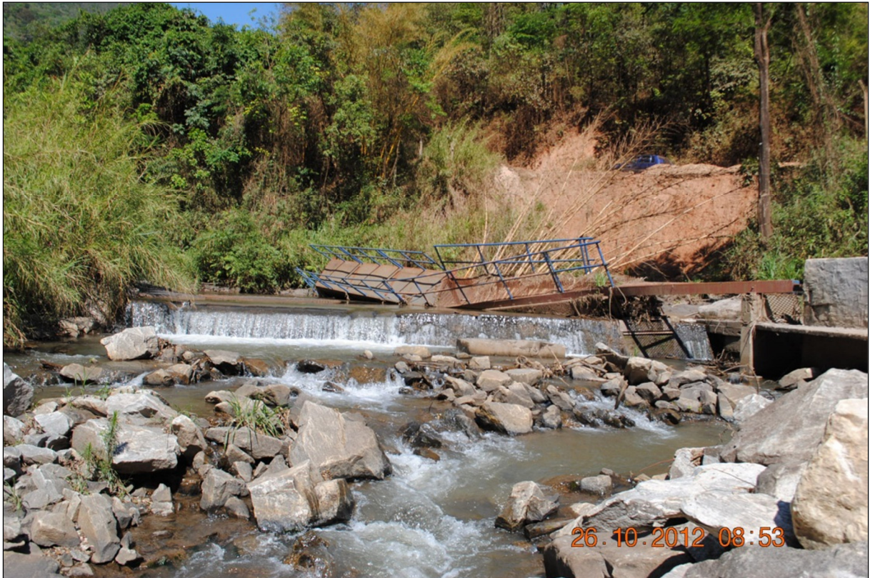
Figura 46. Barragem no Ribeirão do Funil.
