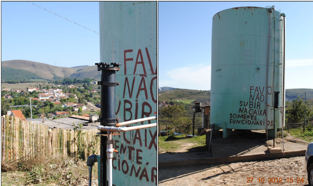
Figura 70. Reservatório e cloração de Rodrigo Silva.
