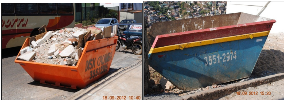
Figura 106. Containers de coleta de resíduos da construção civil.
