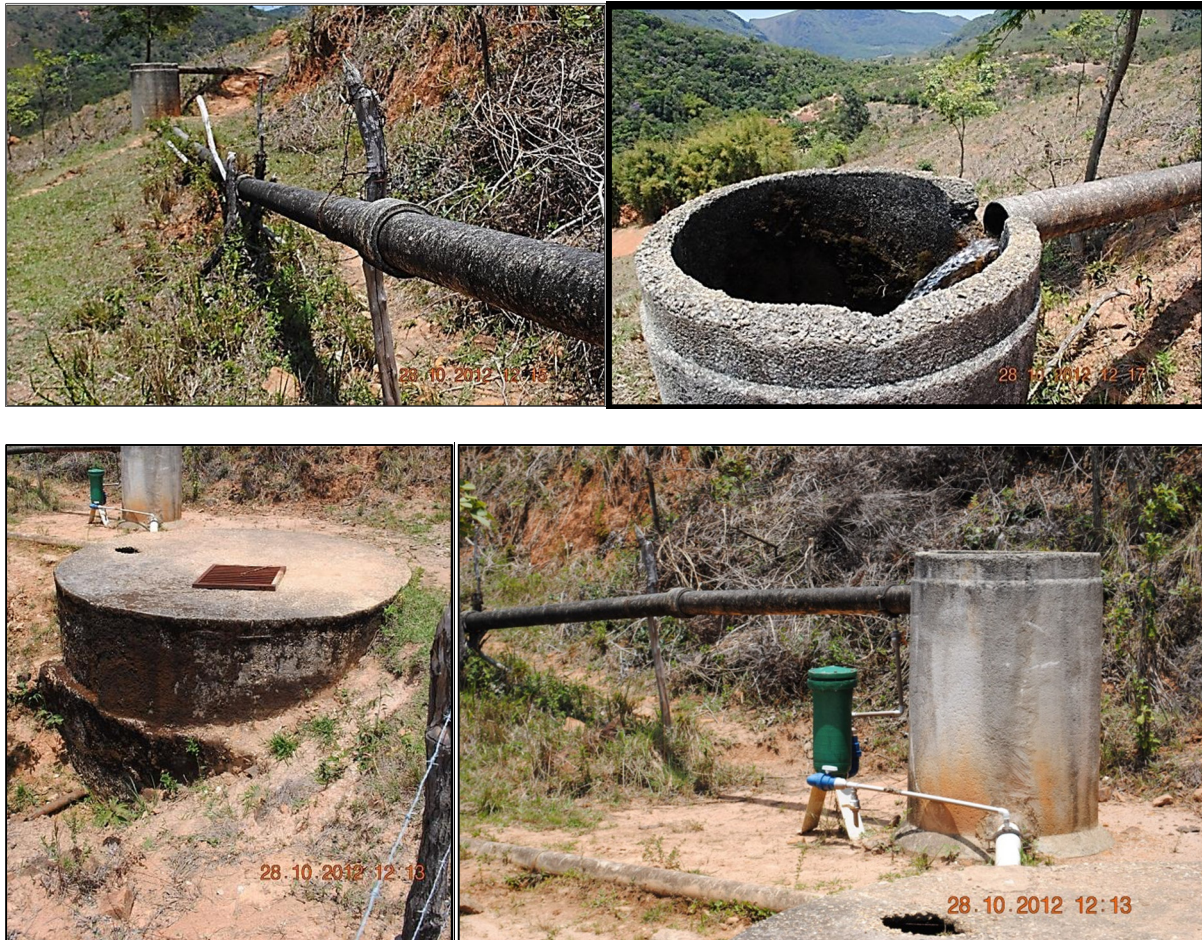
Figura 74. Caixas de passagem do SAA de de Santo Antônio do Salto.
