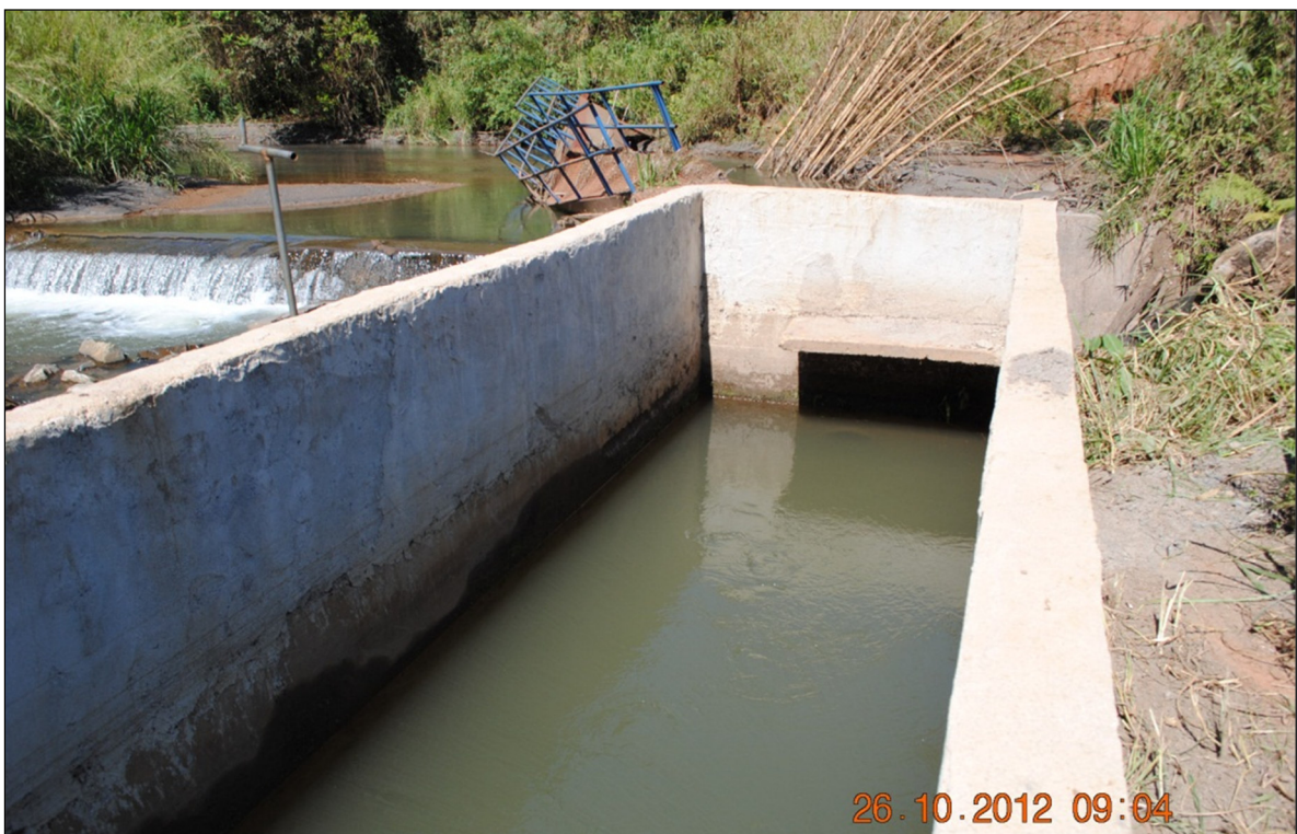
Figura 48. Caixa de areia da captação no ribeirão do Funil.
