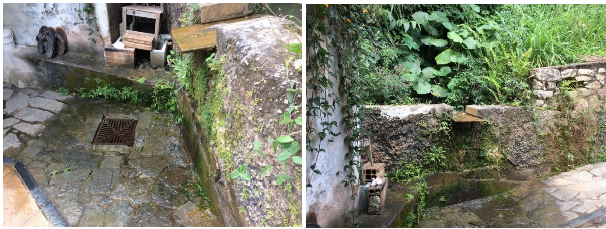
Figura 6.20 – Lago e drenagem da nascente AR - 170
