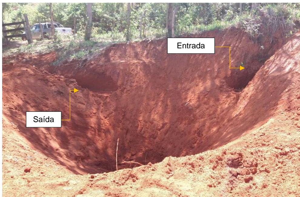
Figura 8 – Diferença de cotas de entrada e saída de água da bacia de contenção
