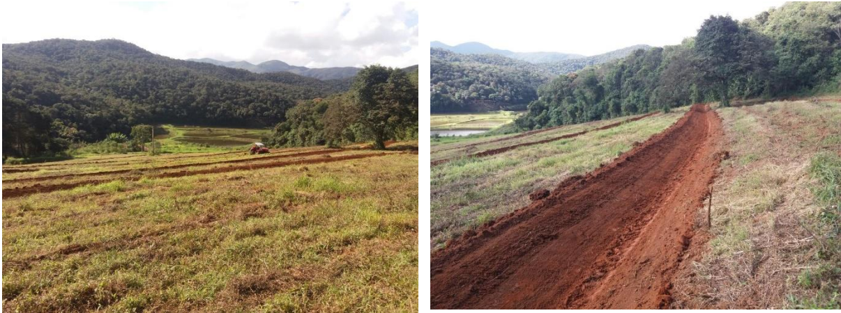
Figura 21 – Execução de terraços em gradiente na Área IV – Microbacia do Córrego São Bartolomeu
