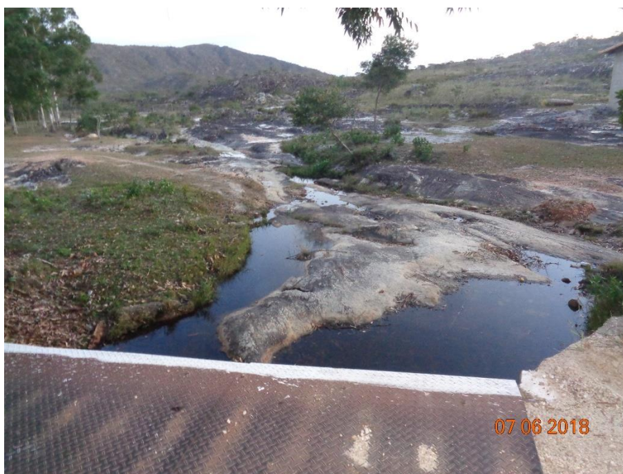
Figura 15 – Assoreamento identificado no Córrego Engenho da Bilia – Área 3 Fonte: LOCALMAQ (2018)
