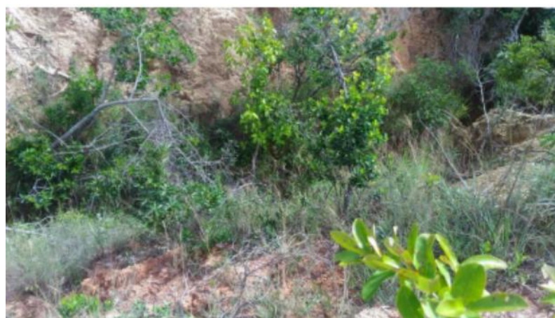
Figura 68 – Área da nascente da microbacia do Córrego Currealinho - projeto hidroambiental UTE Ribeirão Picão
