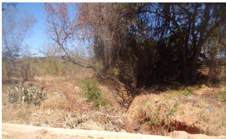
Figura 65 – Drenagem do Córrego “sem nome” na área urbana do município de Corinto, Minas Gerais
