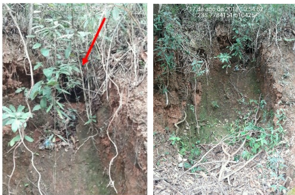
Figura 6-9 – Erosão linear em Macacos com destaque ao ponto de escoamento pluvial – EROF01
