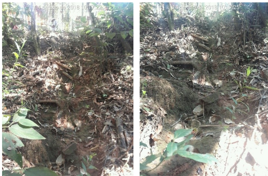
Figura 6-18 – Erosão linear no condomínio Pasárgada – EROT04
