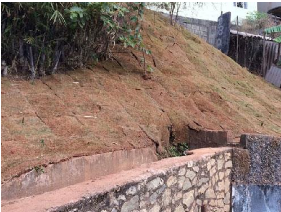
Figura 7 - Vista da área da nascente Bica da Dona Zélia, no bairro Diamante, depois da intervenção
