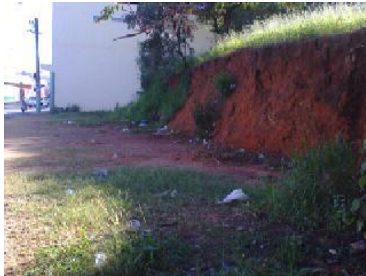
Figura 120: Bota-fora clandestino na Arthur Maloy
