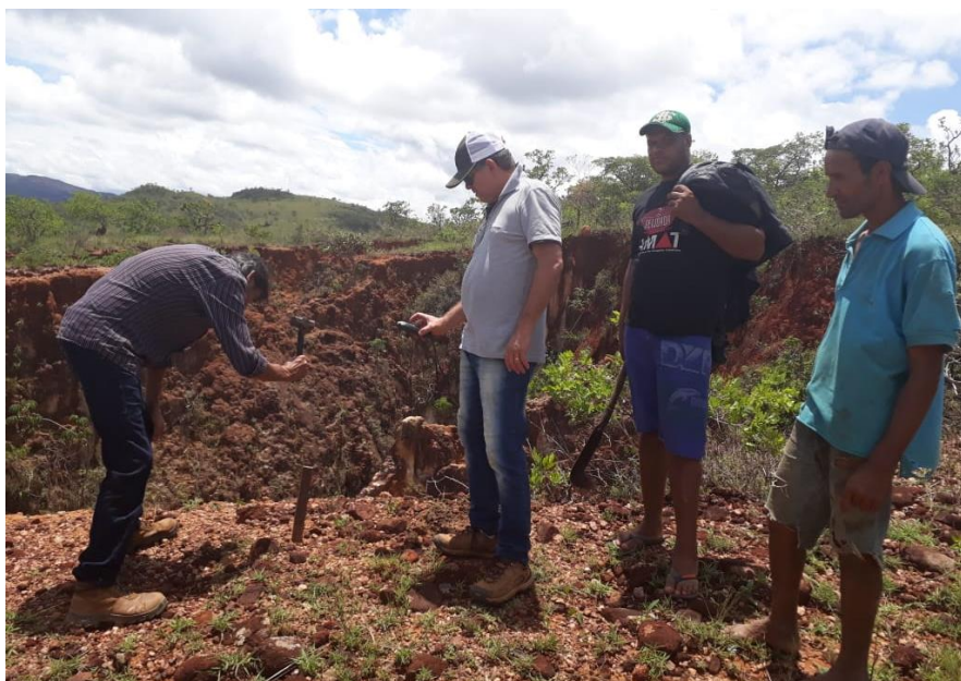
Figura 10 - Locação topográfica realizada no trecho da Proposta 01 - Áreas 01 e 02 do projeto Fonte: LOCALMAQ, 2018
