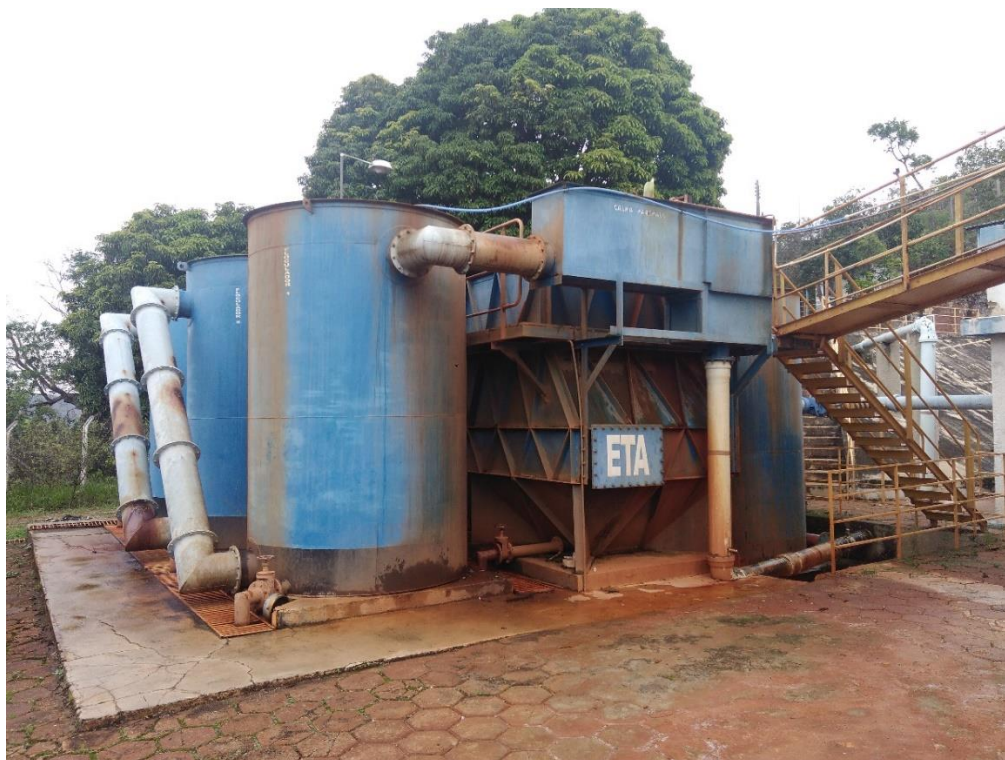
Figura 6.3 - Estação de Tratamento de Água
