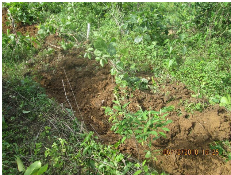
Figura 5.54 – Terraço em gradiente associado à barraginha – 2ª Palestra e atividade prática do projeto hidroambiental – UTE Guaicuí
