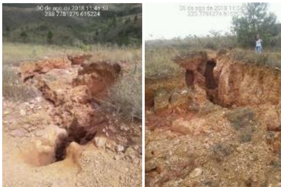
Figura 6-50 – Erosão cuja gênese está relacionada com a atividade de trilhas de motocross em propriedade privada – EROM04/ADEM04 Fonte: Projeta Engenharia (2018)
