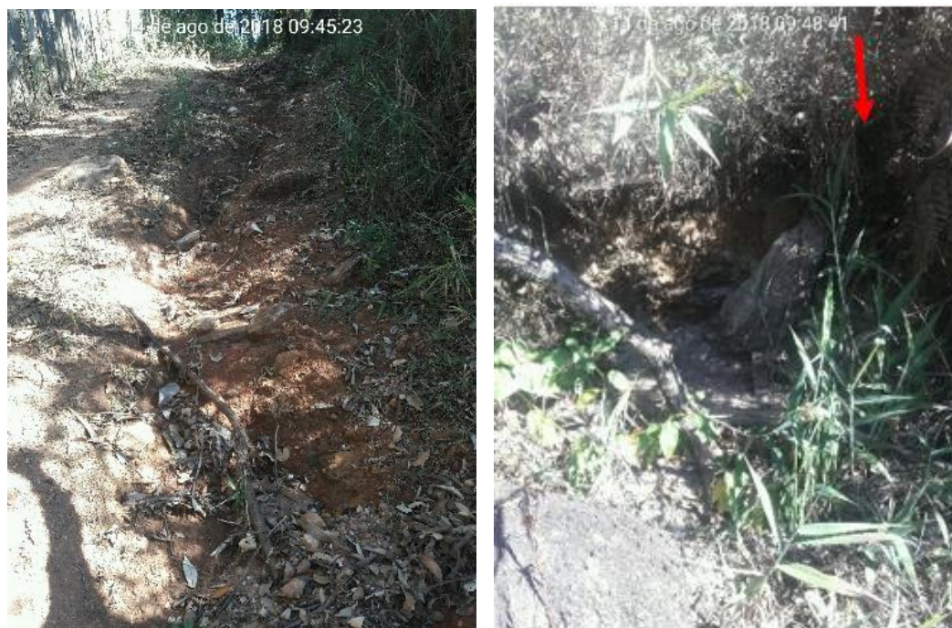
Figura 6-34 – Erosão linear no condomínio Pasárgada, com destaque para o ponto onde escoa uma nascente intermitente – EROT01/ADET01
