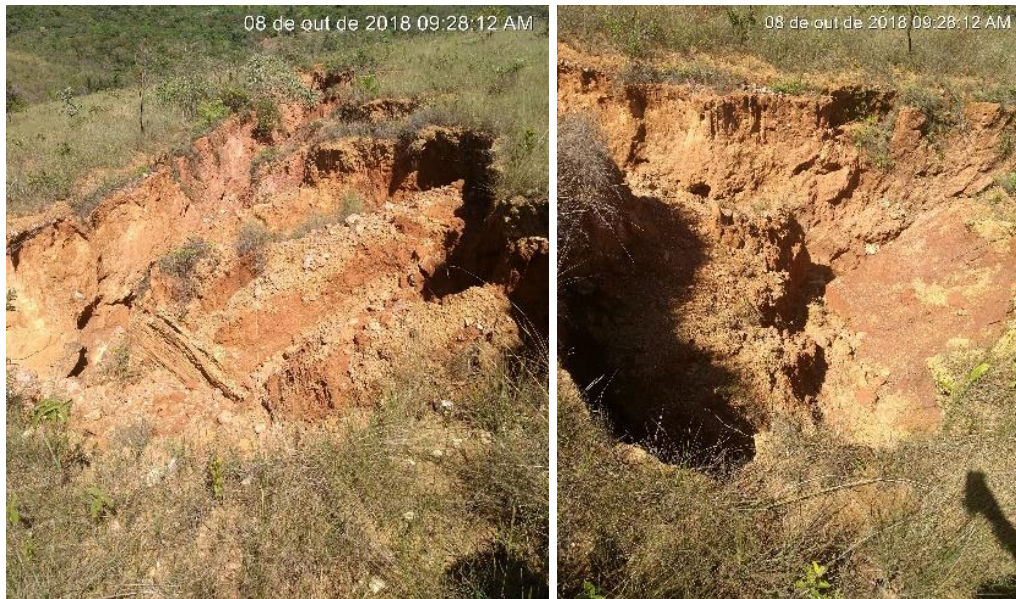
Figura 6-51 – Erosão que representa uma voçoroca de profundidade acentuada e moderado grau de susceptibilidade a erosão do solo – EROM013/ADEM013 Fonte: Projeta Engenharia (2018)
