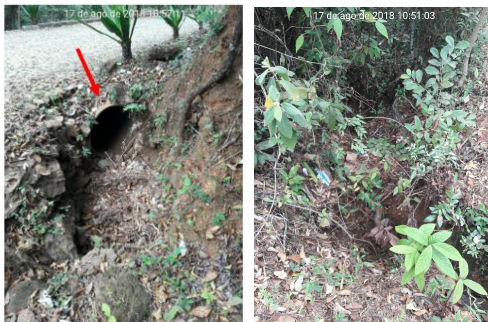
Figura 6-19 – Erosão linear em Macacos, com destaque para a manilha de drenagem de água pluvial – EROF02/ADEF02
