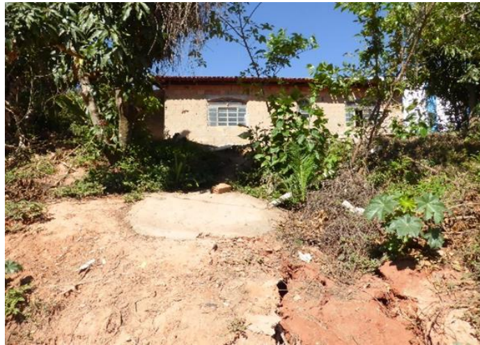
Figura 22 - Fossa negra em residência do distrito de Acuruí (Itabirito). Portal CBH Rio das Velhas, 2016.
