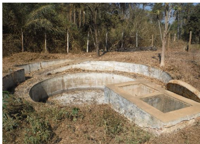
Figura 21 - Leito de secagem de efluente doméstico inoperante no distrito de São José de Almeida (Jaboticatubas). Portal CBH Rio das Velhas, 2016.
