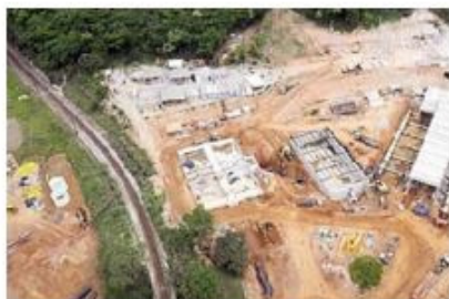
A Copasa informou que 70% das obras do novo sistema de captação do rio Paraopeba já estão concluídas. Divulgação
