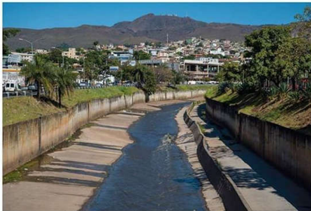
Ribeirão Arrudas em Belo Horizonte - UTE Ribeirão Arrudas.
