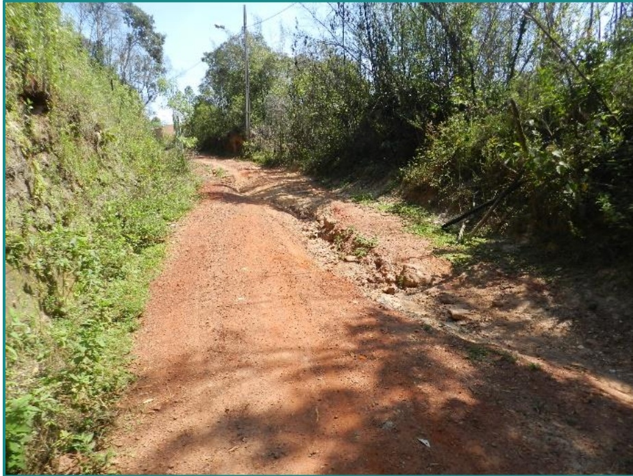
Figura 262 - Evolução de processos erosivos (ravina para voçoroca) na estrada de acesso ao PNMA via Morro São Sebastião. Fonte: Myr Projetos, 2016.
