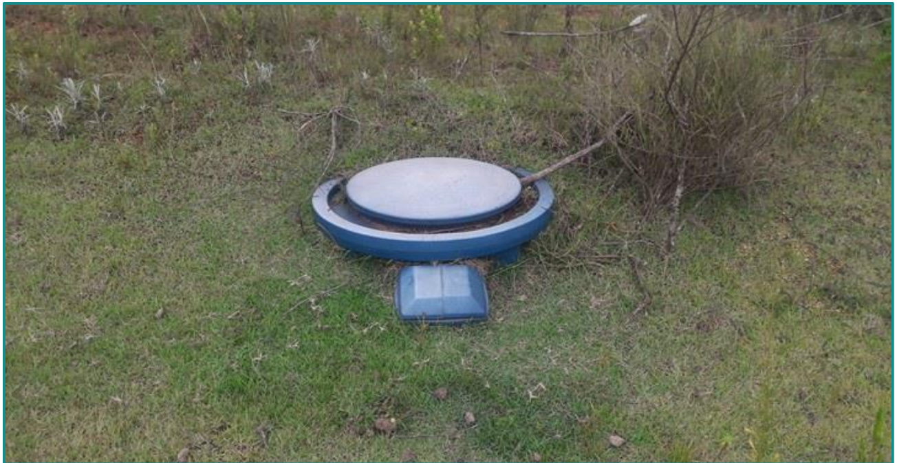
Figura 48 - Estação de tratamento anaeróbico. Fonte: Myr Projetos, 2016.
