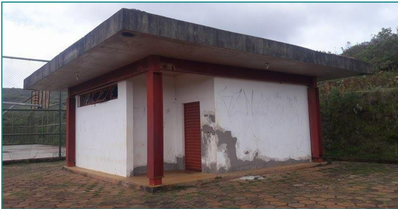
Figura 39 - Banheiros do centro esportivo (sem condições de uso). Fonte: Myr Projetos, 2016.
