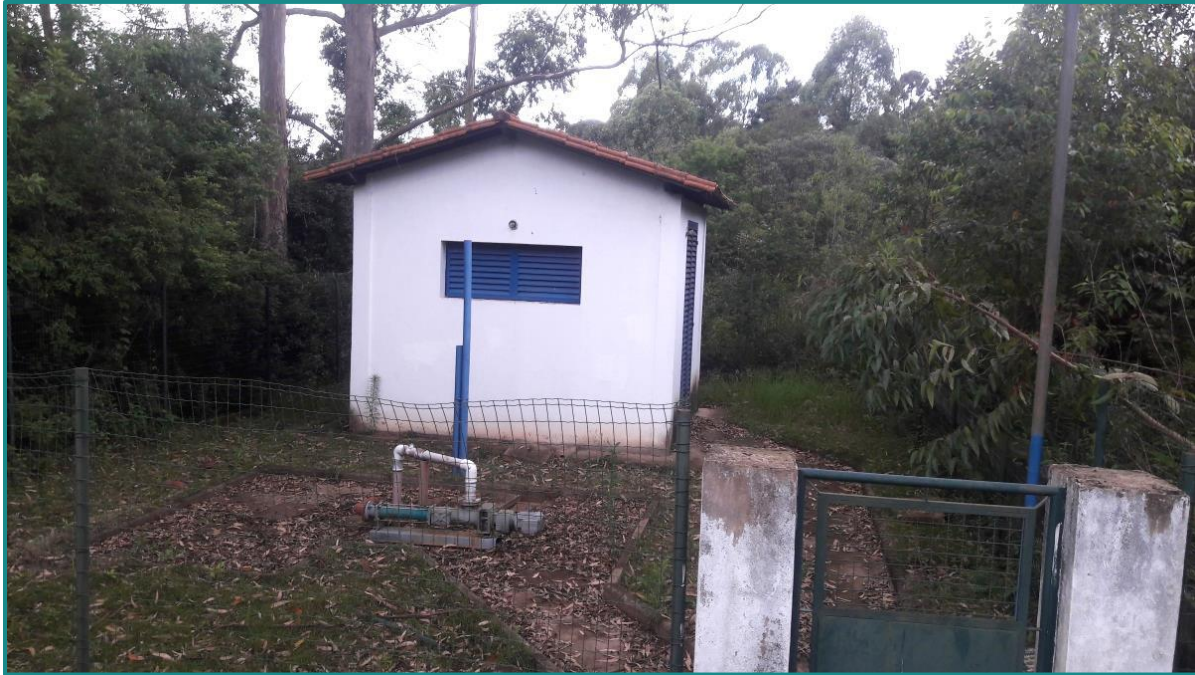
Figura 94 – Estação de Elevação no Morro de São Sebastião. Fonte: Myr Projetos, 2016.
