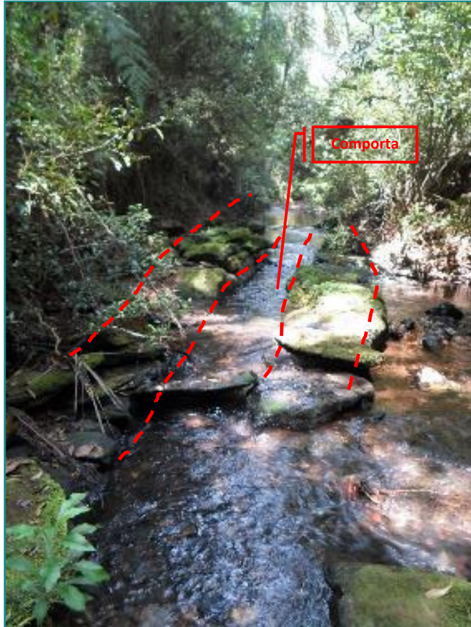
Figura 189 – Provável estrutura de mineração, aparentemente usada para desvio de água. Fonte: Myr Projetos, 2016.
