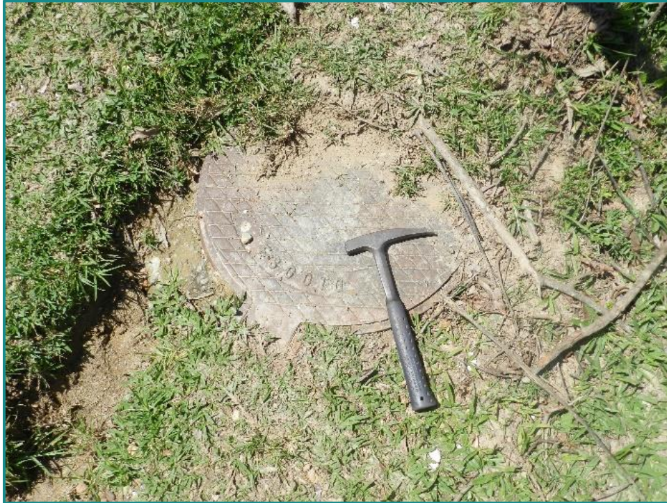
Figura 282 - Ponto de tubulação de esgoto oriunda do bairro São Sebastião direcionado para a nascente. Fonte: Myr Projetos, 2016.
