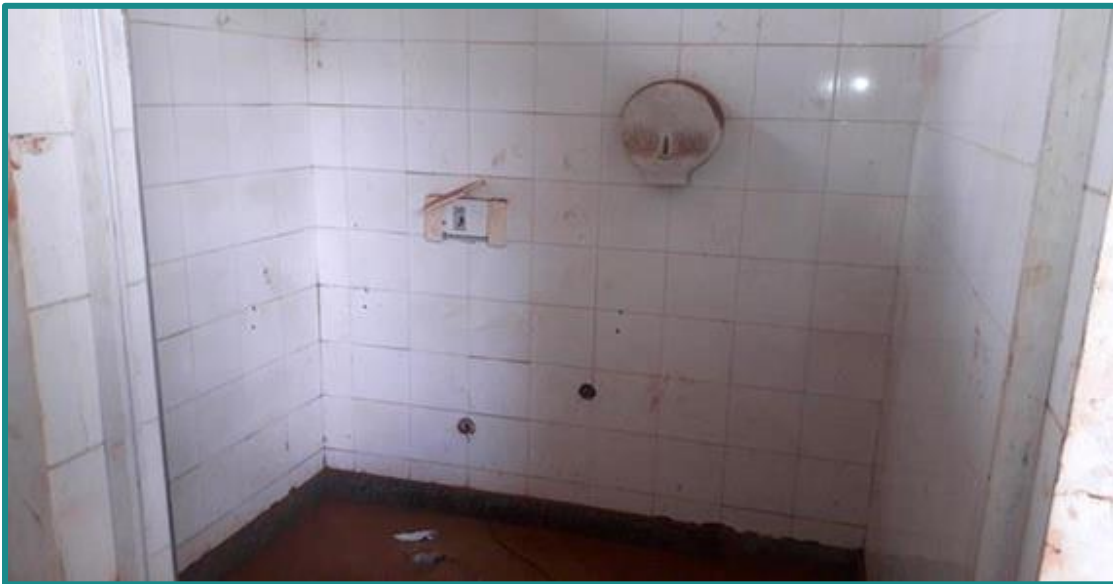
Figura 18 - Instalações sanitárias da guarita danificada. Fonte: Myr Projetos, 2016.
