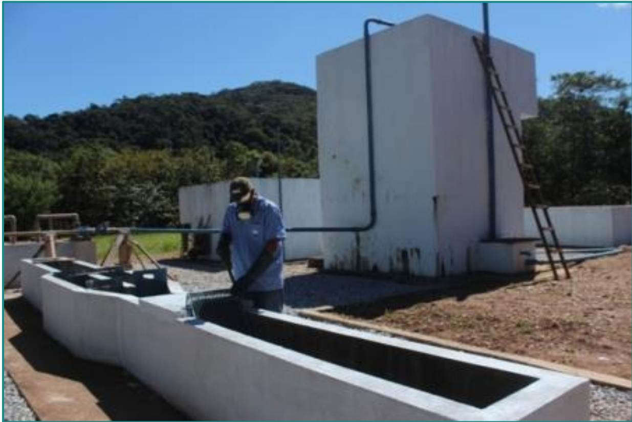
Figura 93 – ETE do distrito de São Bartolomeu. Fonte: Portal da SEMAE OP, 2016.
