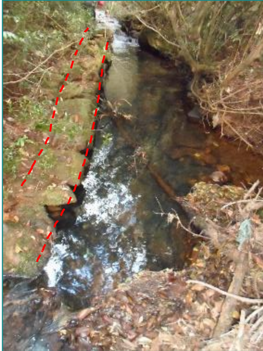
Figura 186 - Muro em pedra e junta seca, provável estrutura de mineração, com aparente canal de desvio de água. Fonte: Myr Projetos, 2016.
