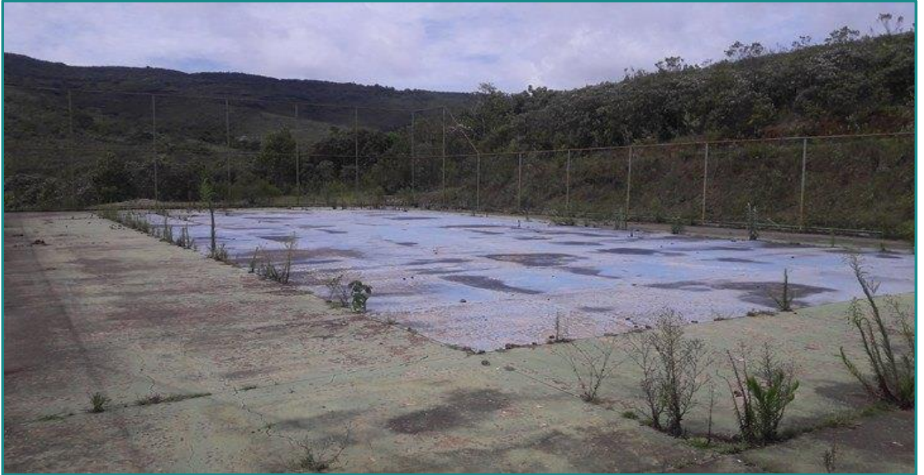
Figura 42 - Quadra de tênis (sem condições de uso). Fonte: Myr Projetos, 2016.
