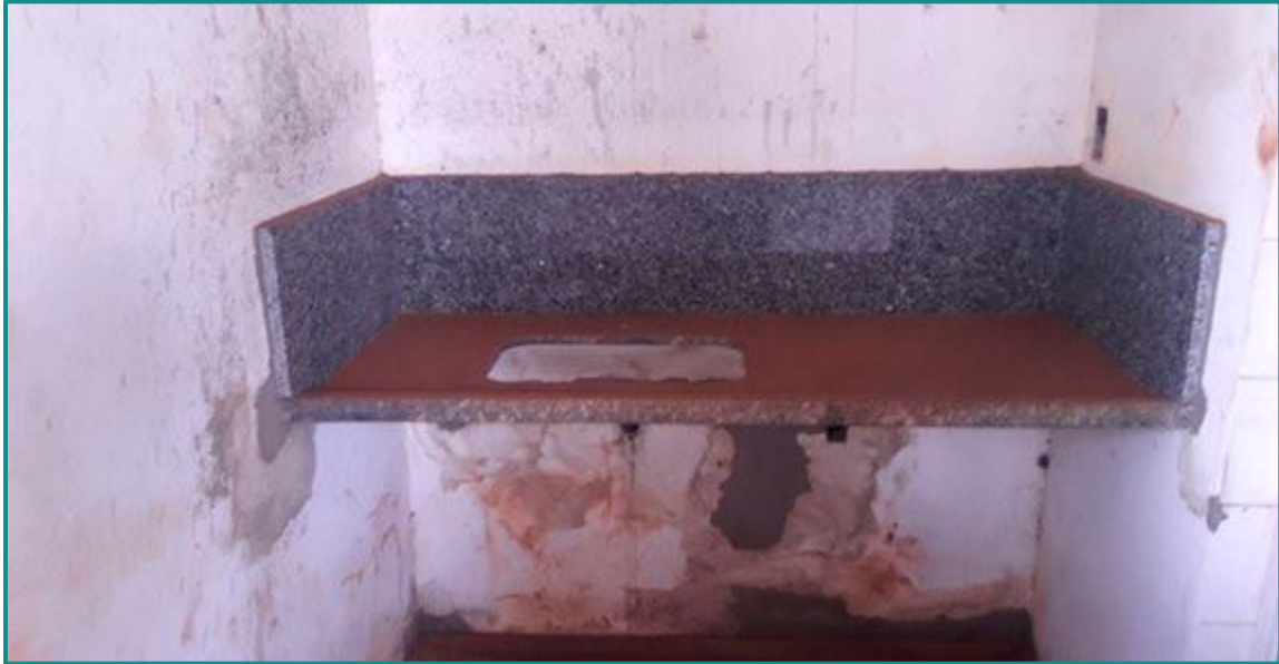
Figura 17 - Estrutura da guarita danificada. Fonte: Myr Projetos, 2016.
