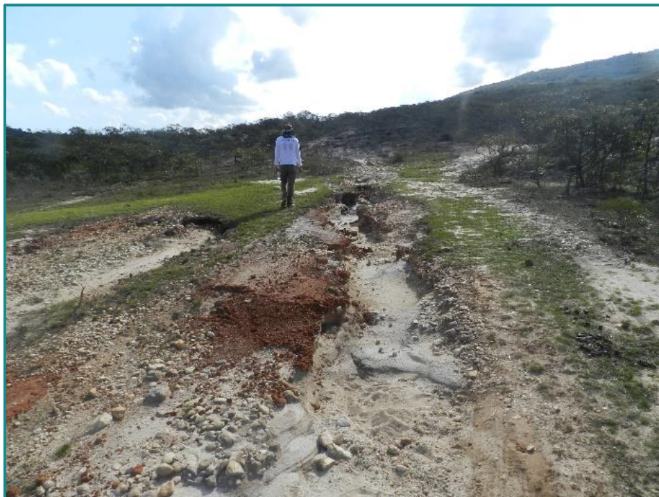
Figura 263 - Voçoroca instalada no interior do PNMA provocada pelo uso como trilha de motocicleta e acesso de carro a moradia existente no parque. Fonte: Myr Projetos, 2016.
