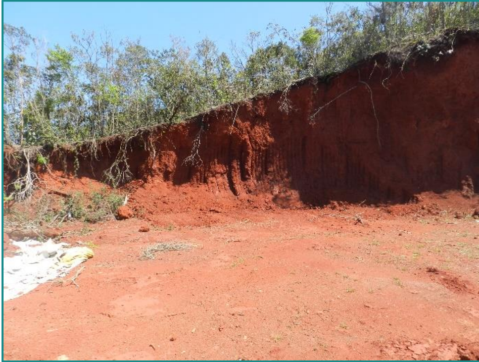
Figura 264 - Evidências da instabilidade de taludes na Serra da Brígida. Fonte: Myr Projetos, 2016.
