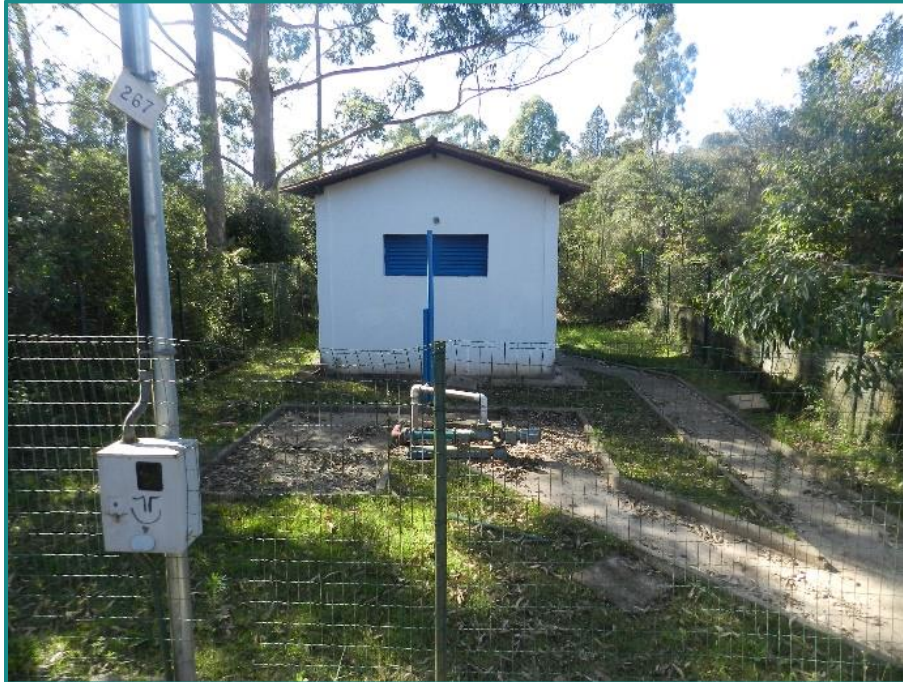
Figura 280 - Estrutura elevatória de esgoto presente na área das Camarinhas. Fonte: Myr Projetos, 2016.
