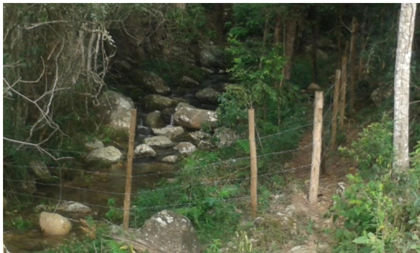
Figura 17: Construção de cerca na propriedade do Sr. Tatão. Fonte: Arquivo fotográfico GOS Florestal.
